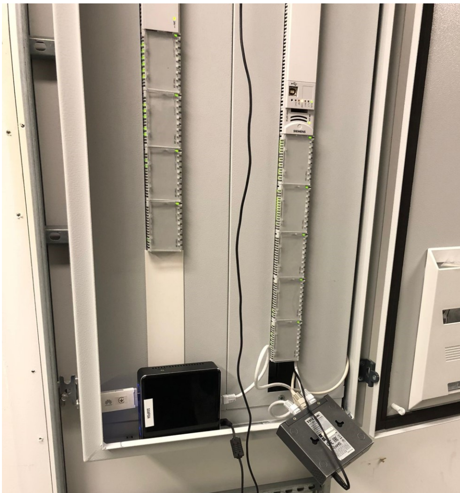
Kuva 7. Projektin kohteen VAK-kaappi, näkyvillä myös Mini-PC ja verkkokytkin.
