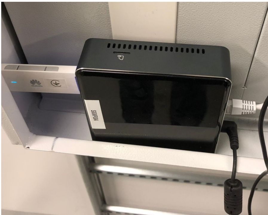
Kuva 9. Mini-PC asennettuna kohteessa.
