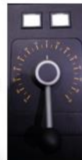
Bild 9.4 Handstyrningen på brygga B, C, D
