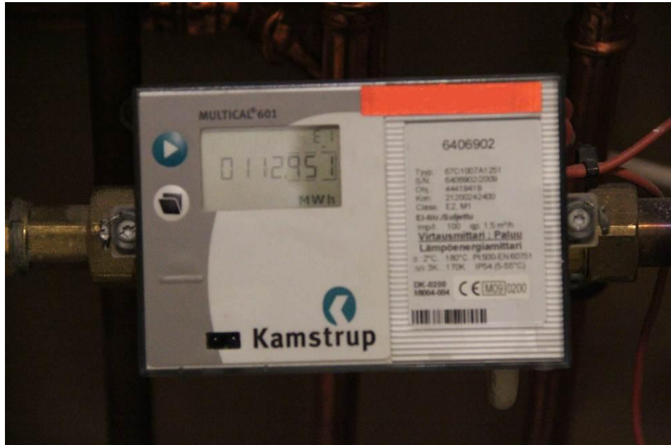
Kuva 8. Lämpöenergiamittari Kamstrup Multical 601
