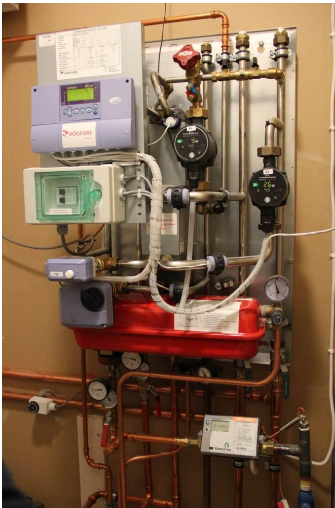
Kuva 7. Högforsin omakotitalon kaukolämpöpaketti
