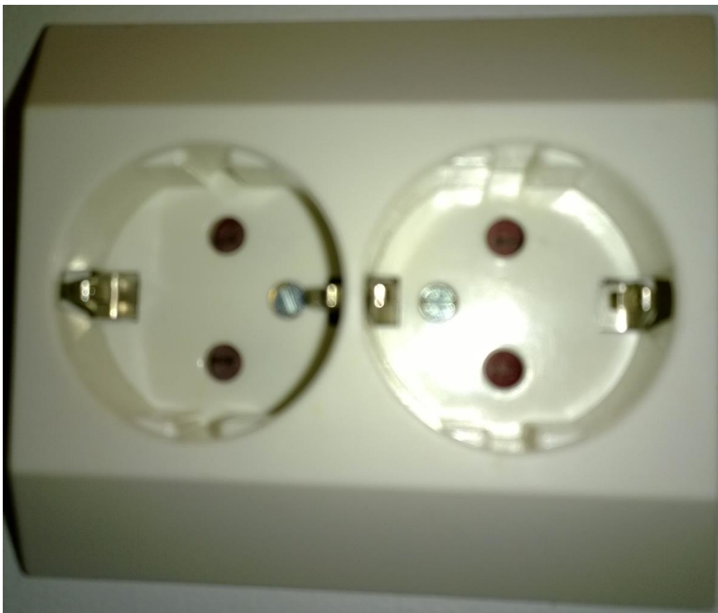
Sähköpiste ennen päivitysprojektia
