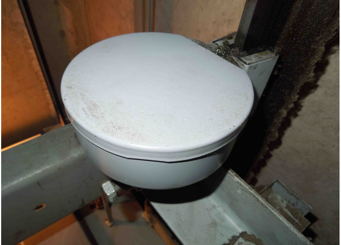
Kuva 22. Korin johteen voiteluautomaatti.
