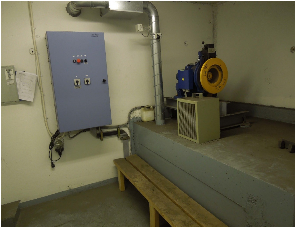
Kuva 9. Konehuone perussiivouksen tarpeessa.
