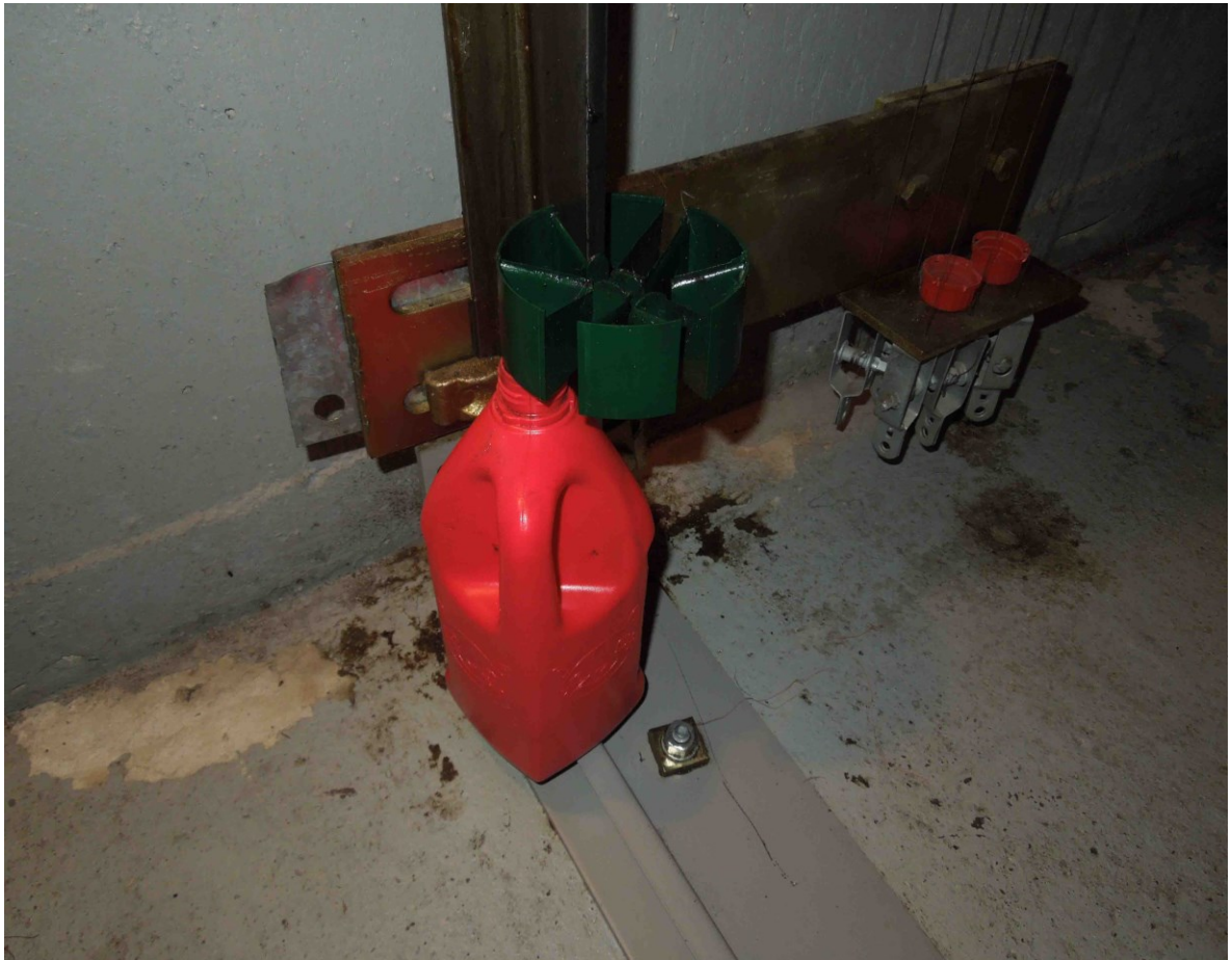
Kuva 27. Johteen öljynkeräyskuppi kuilun pohjalla.
