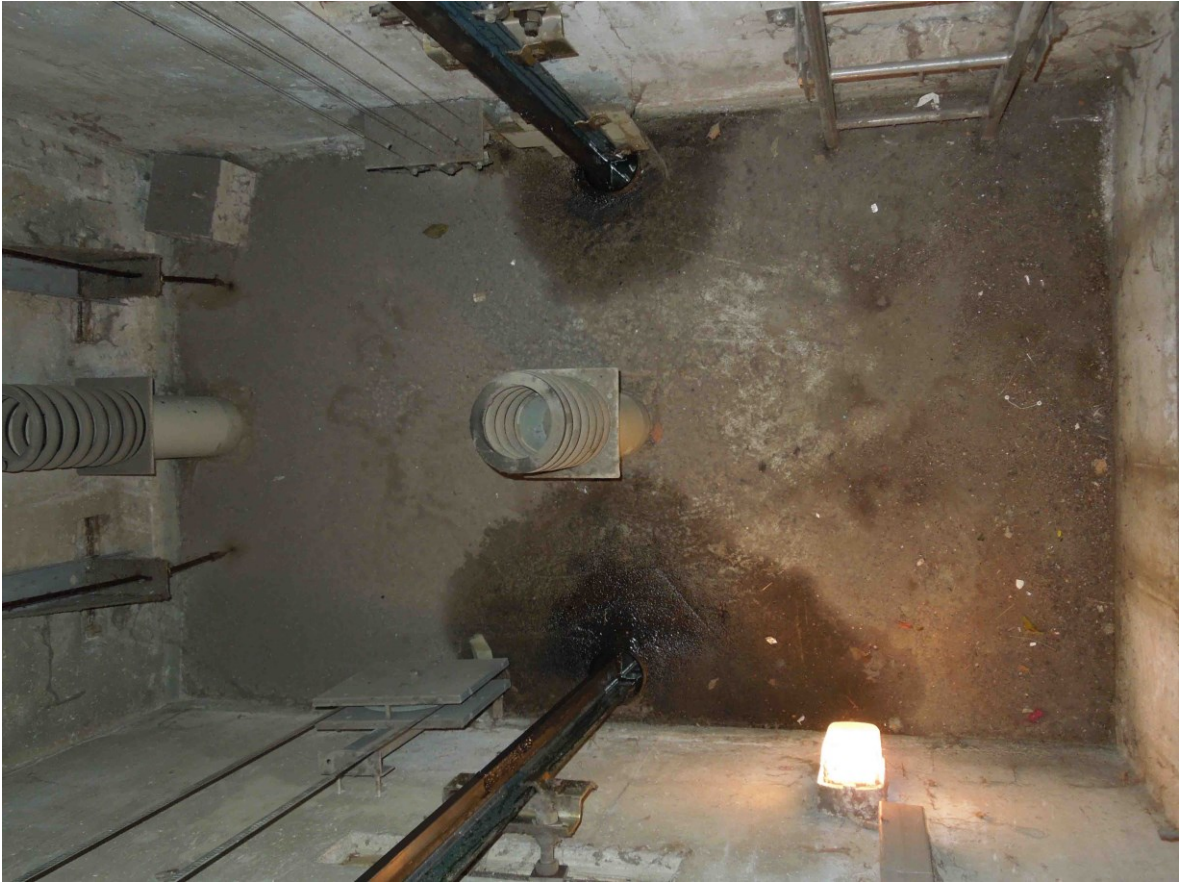
Kuva 26. Edellisen kuvan kuilun pohja ennen siivousta.
