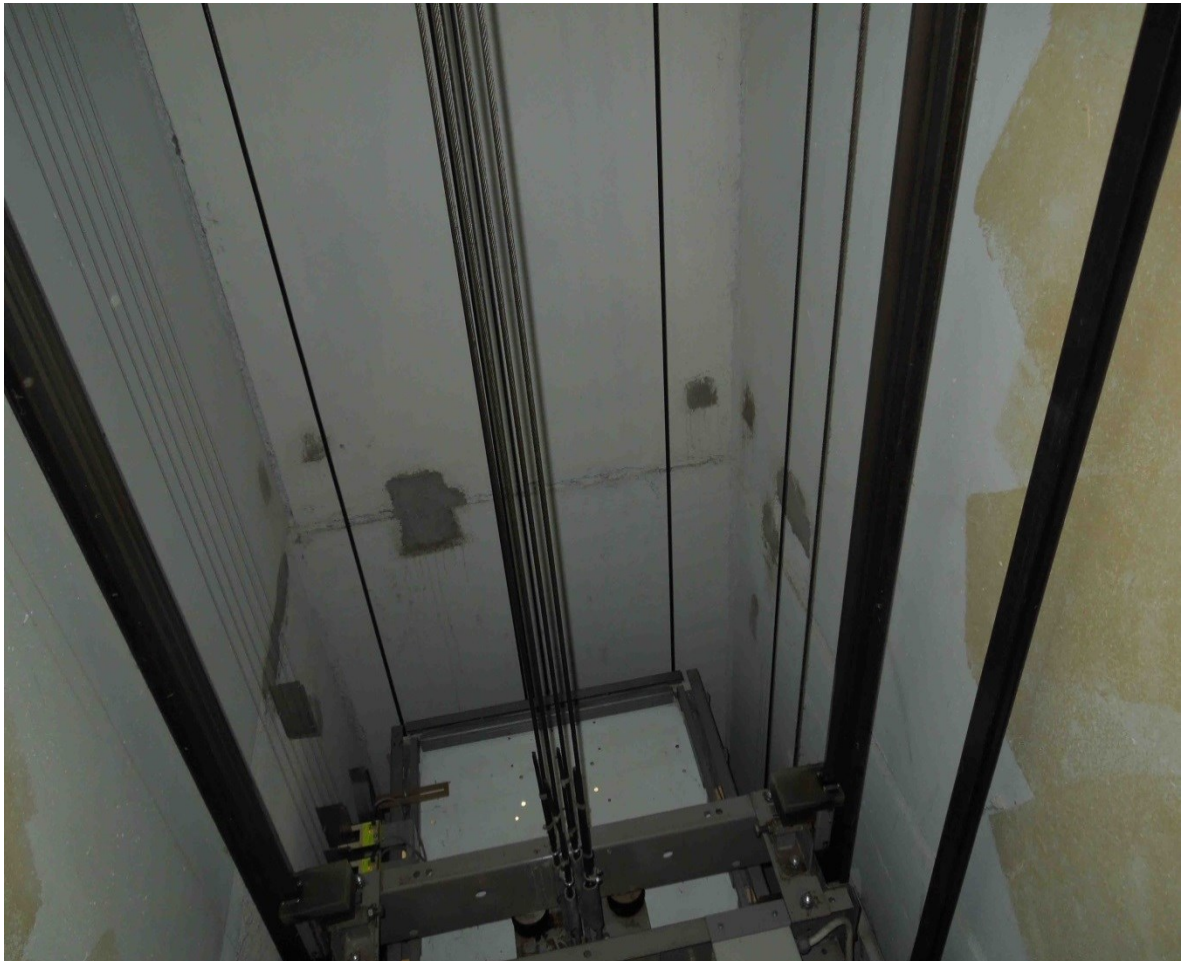
Kuva 19. Korikaapelit, nopeudenrajoittajan köysi ja paikkatietolaitteet kuilussa.
