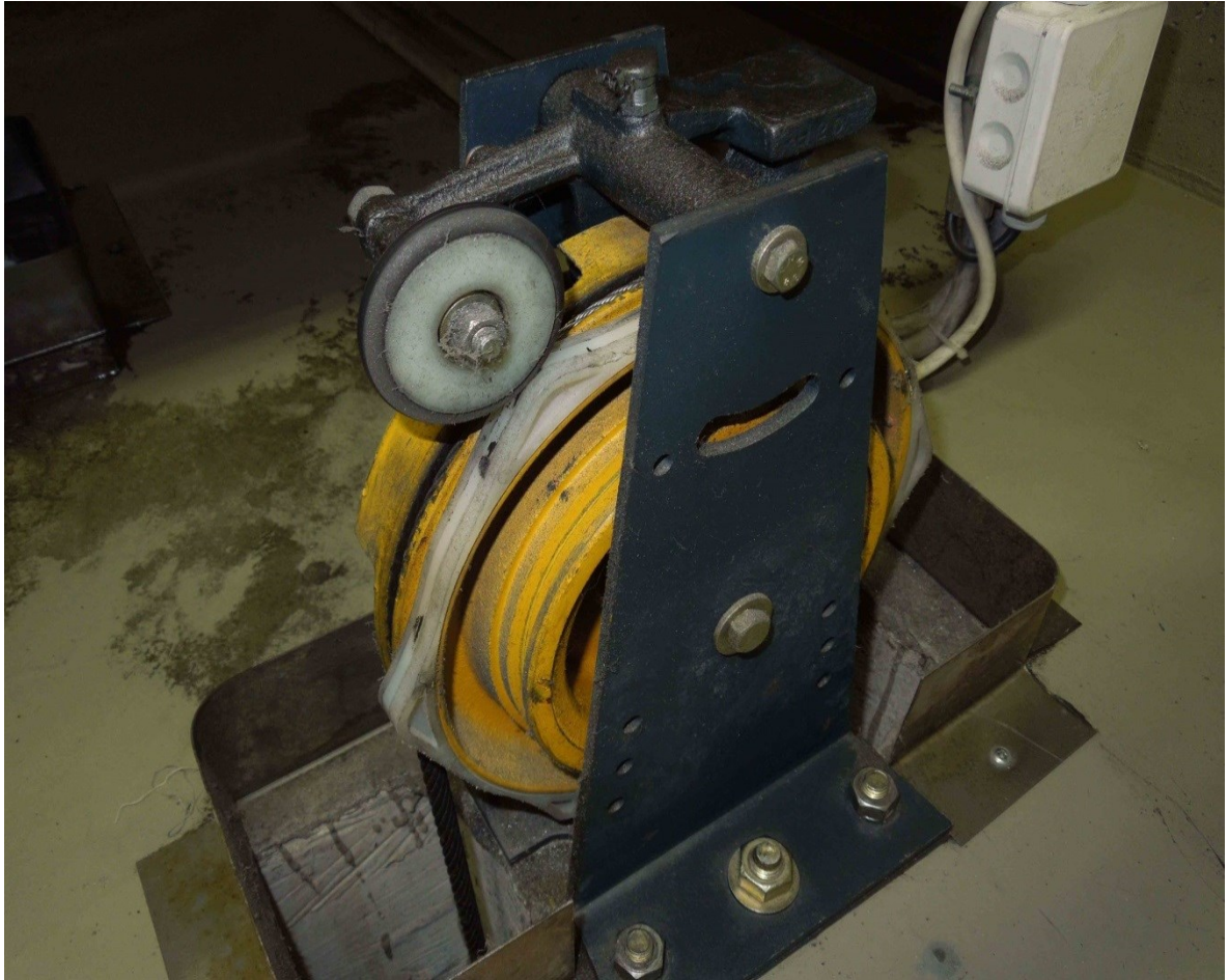
Kuva 15. Nopeudenrajoittajan taittopyörä konehuoneessa.
