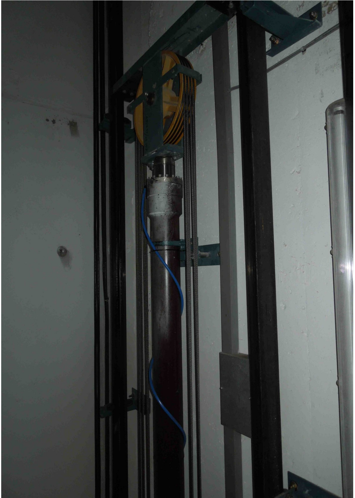
Kuva 42. Hydraulinhissin sylinteri ja sen taittopyörä kuilussa.
