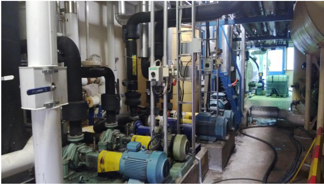
Kuvio 24. Jäähdytysjärjestelmään kuuluvia pumppuja ja putkistoja.
