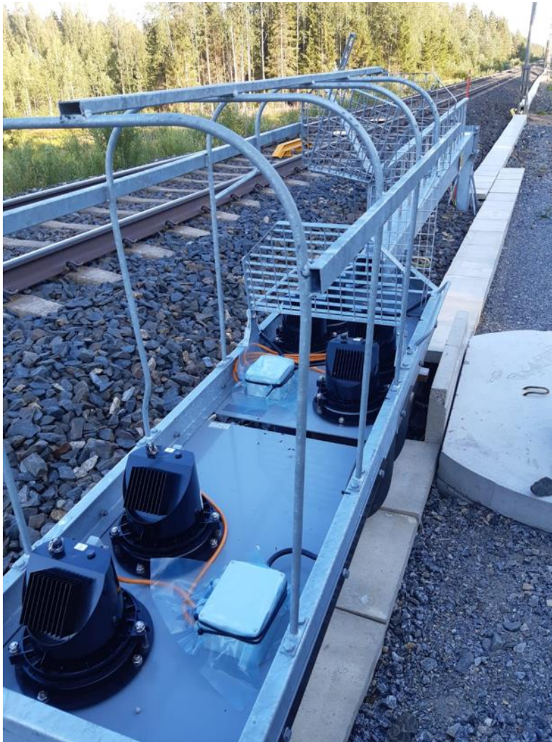
Kuva 9. Pääopastin, jolla ohjataan junaliikennettä. Tämä opastintyyppi nostetaan käyttöönottovaiheessa pystyyn. Kuvattu TASE-projektilla kesällä 2021.
