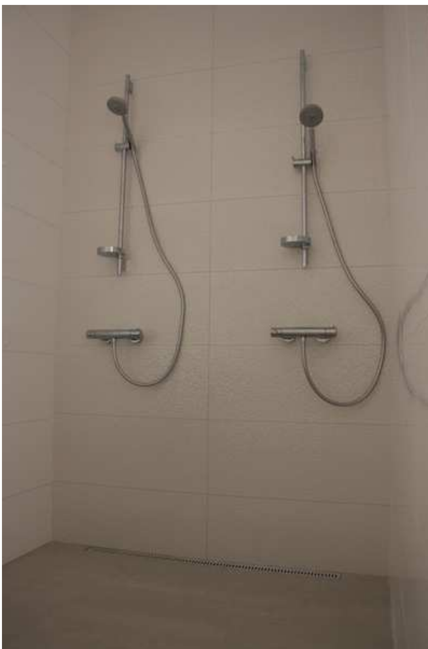
Kuva 17 Laattasaumat eivät jatku yhtenäisinä seinältä toiselle [16]
