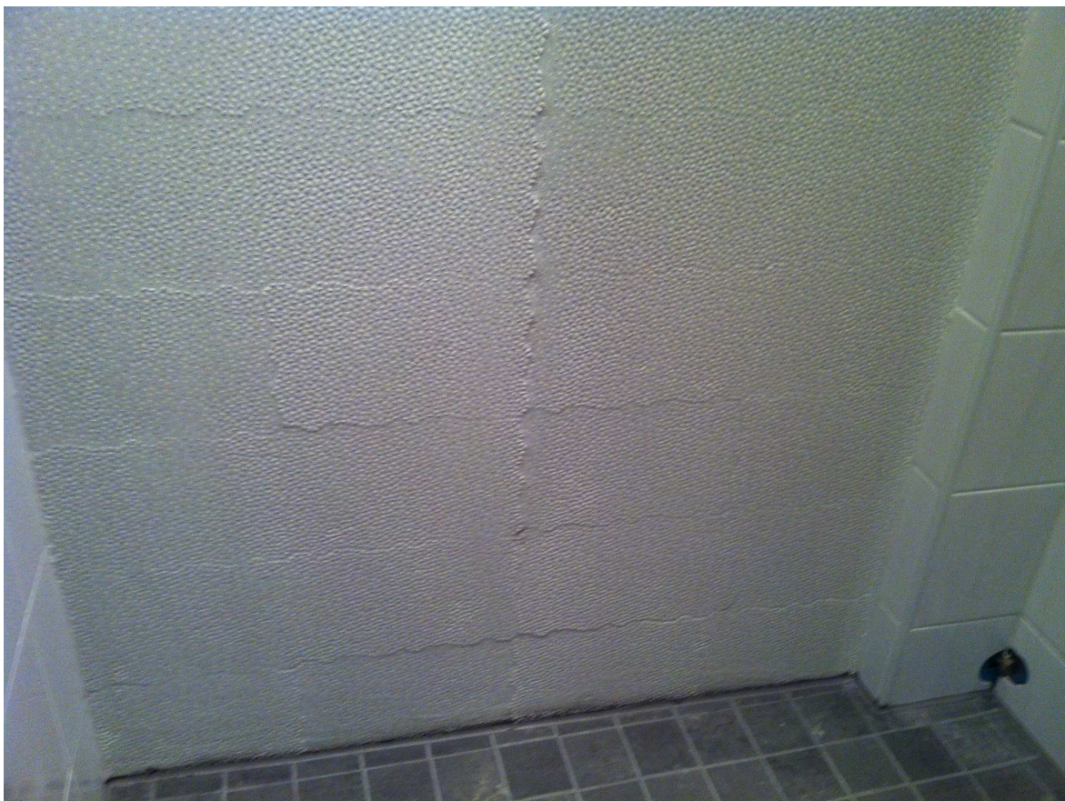
Kuva 14 Alustan tasoitus on tehty huonosti [16]
