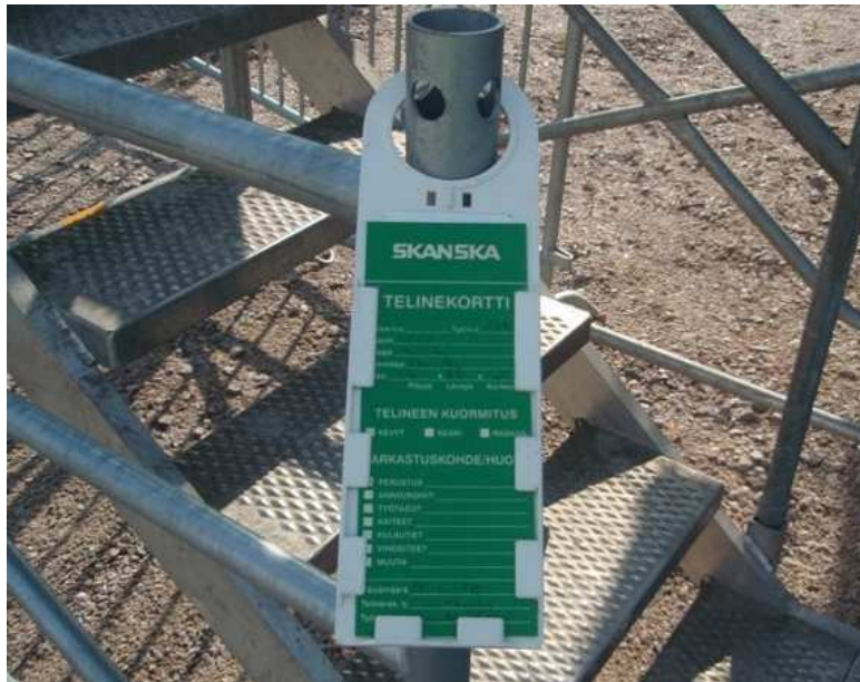
Kuva 8. Telinekortti laitetaan käyttöönottotarkastuksen jälkeen näkyvälle
