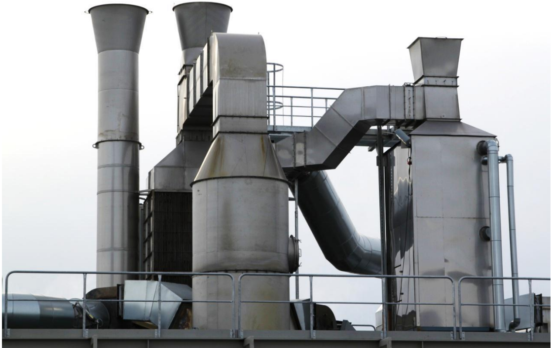
Kuva 8. Lämmön talteenottotorneja tehtaan katolla.
