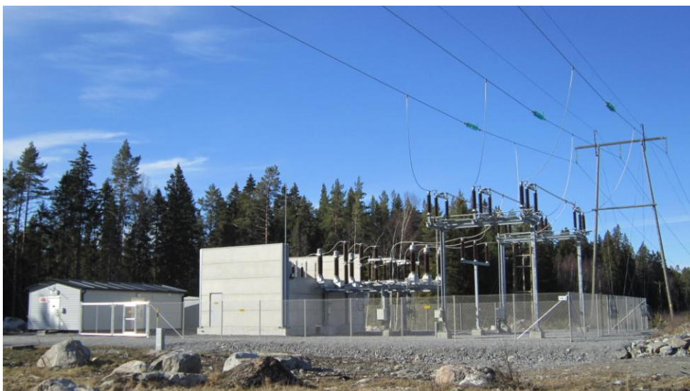
Kuva 5. Tuulivoimalan yhteyteen sijoitettu ABB:n sähköasema.
