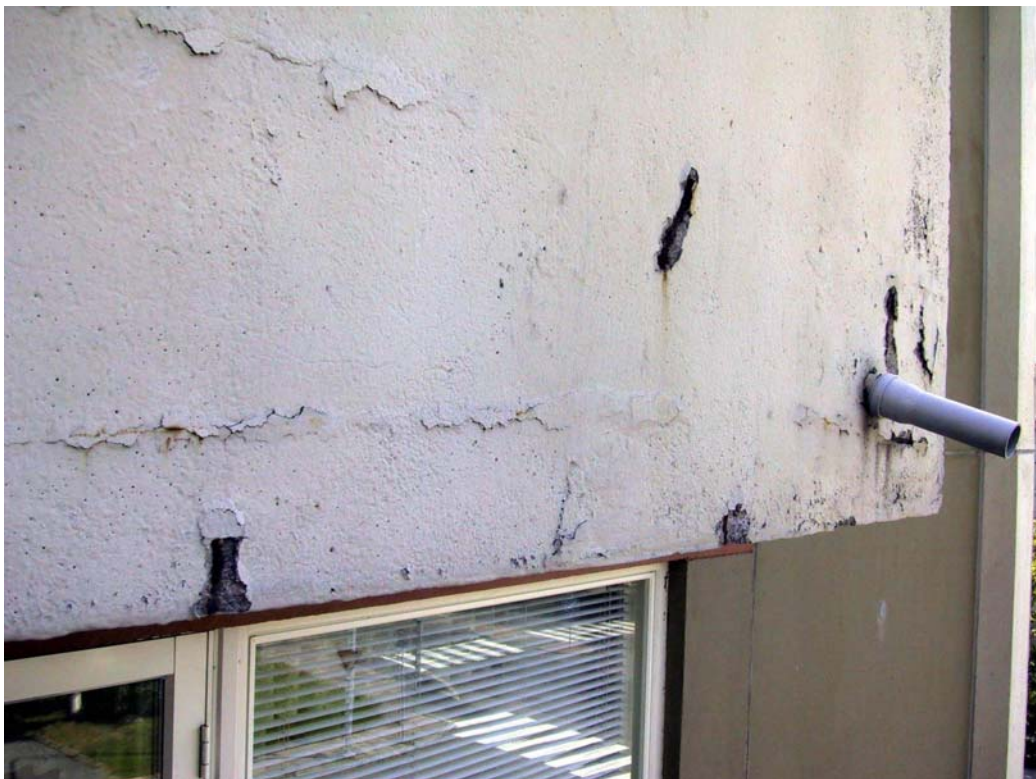
Kuva 8. Korroosion vaurioittama betoninen parvekekaide. [11, s. 8]
