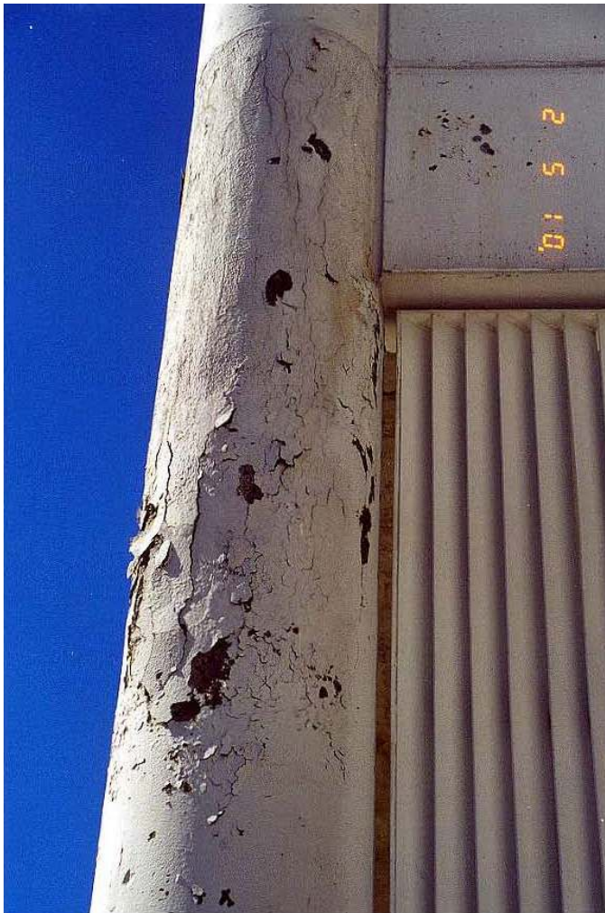
Kuva 10. Pakkasrapautumisen aiheuttamaa halkeamaa. [11, s. 9]
