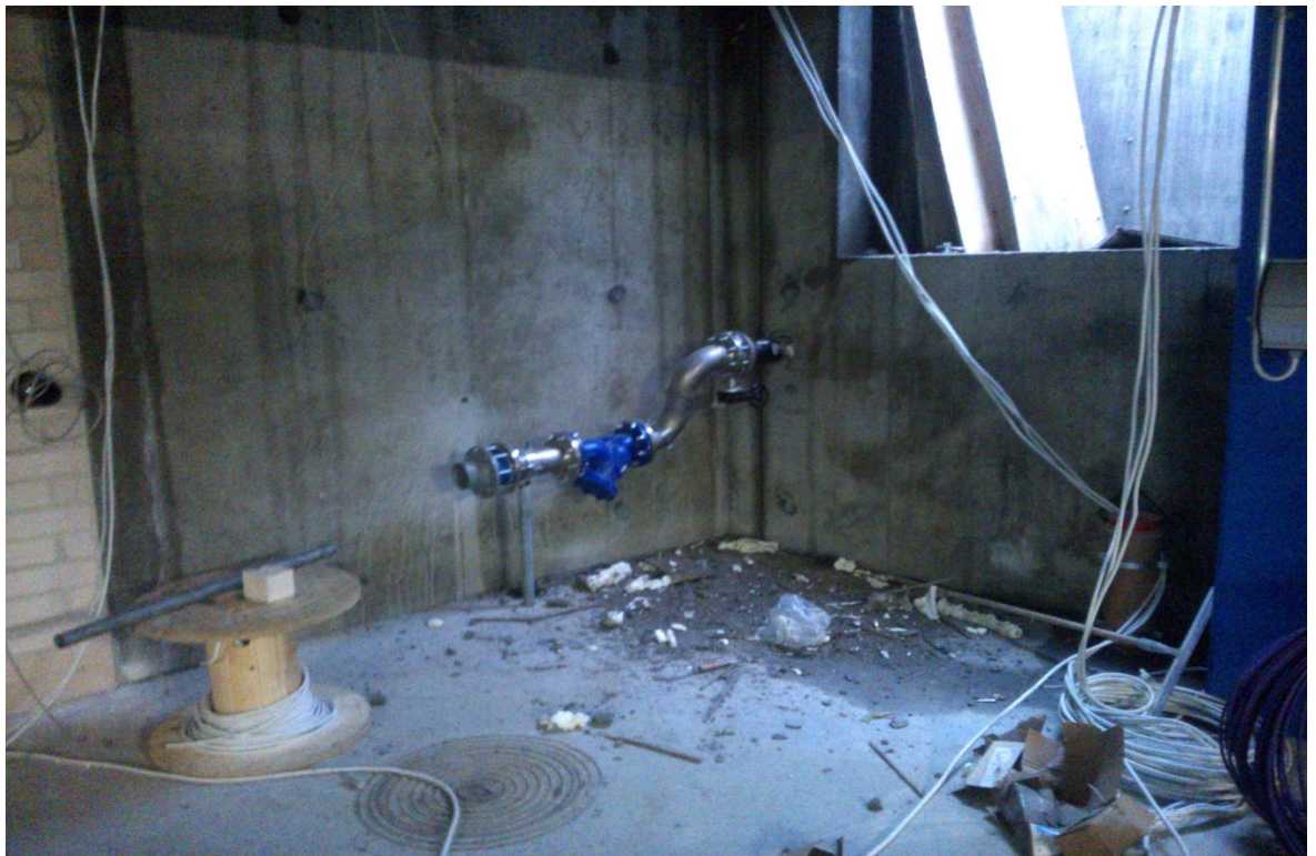
Kuva 7. Sprinklerikeskuksen pääsulkuventtiili, mudanerotin ja yksisuuntaventtiili asennettuina.
