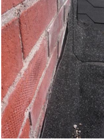
Kuva 39. Huopa irronnut läpiviennistä. [29.]
