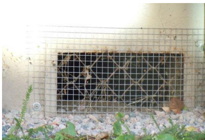
Kuva 22. Tuulettuvan alapohjan tuuletusaukon virheellinen sijainti maaperään nähden. [21.]
