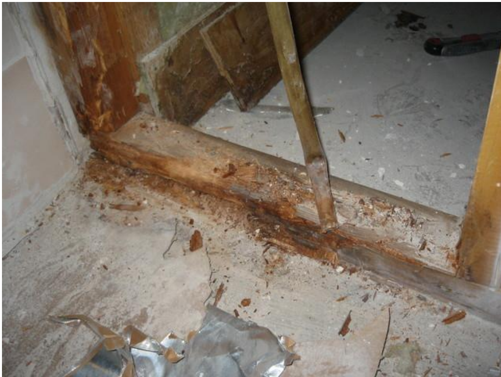
Kuva 13. Lahovaurioita väliseinän alaohjauspuussa. [14.]
