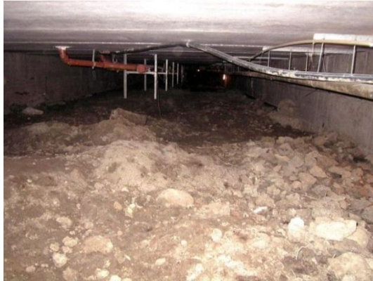
Kuva 19. Tuulettuvan alapohjan perusmaa aiheuttaa kosteushaittoja rakenteissa. [20.]
