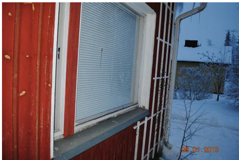
Kuva 26. Ikkunan pellityksen kaato on puutteellinen.
