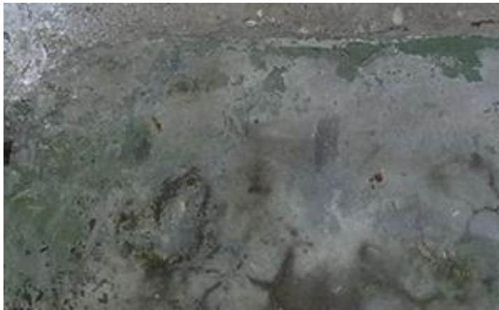
Kuva 9. Irronnut pinnoite ja betonin värjäytyminen maanvaraisessa betonilaatassa kosteuden takia. [10.]
