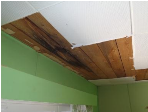
Kuva 40. Vesikatteen vuoto ilmenee sisäkaton tummumisena. [29.]
