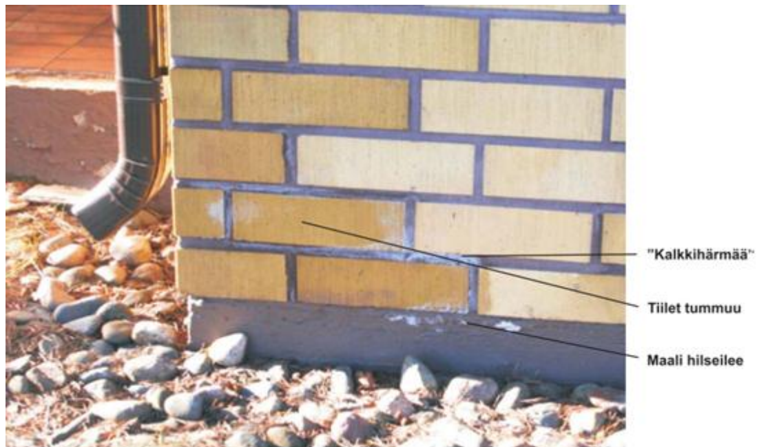
Kuva 30. Tiiliverhouksessa kosteuden aiheuttamia jälkiä. [22.]
