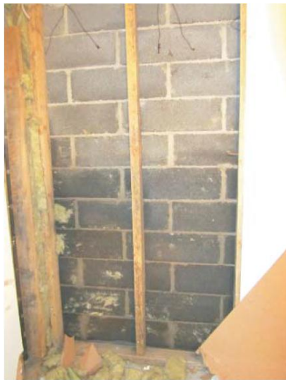
Kuva 44. Kosteus nousee kapillaarisesti kellarin seinässä. [29.]
