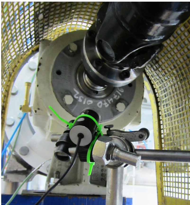
Kuva 29. Kytkinsuojan alle asennettu kamera, joka lähetti reaaliaikaista kuvaa valvomokoppiin
