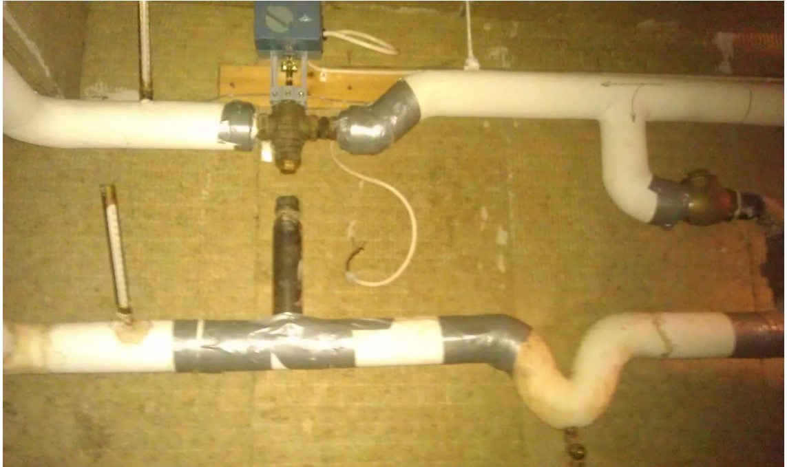
KUVA 10. Kellarin ilmanvaihtokonehuoneen putkituksia (21.11.2012)
