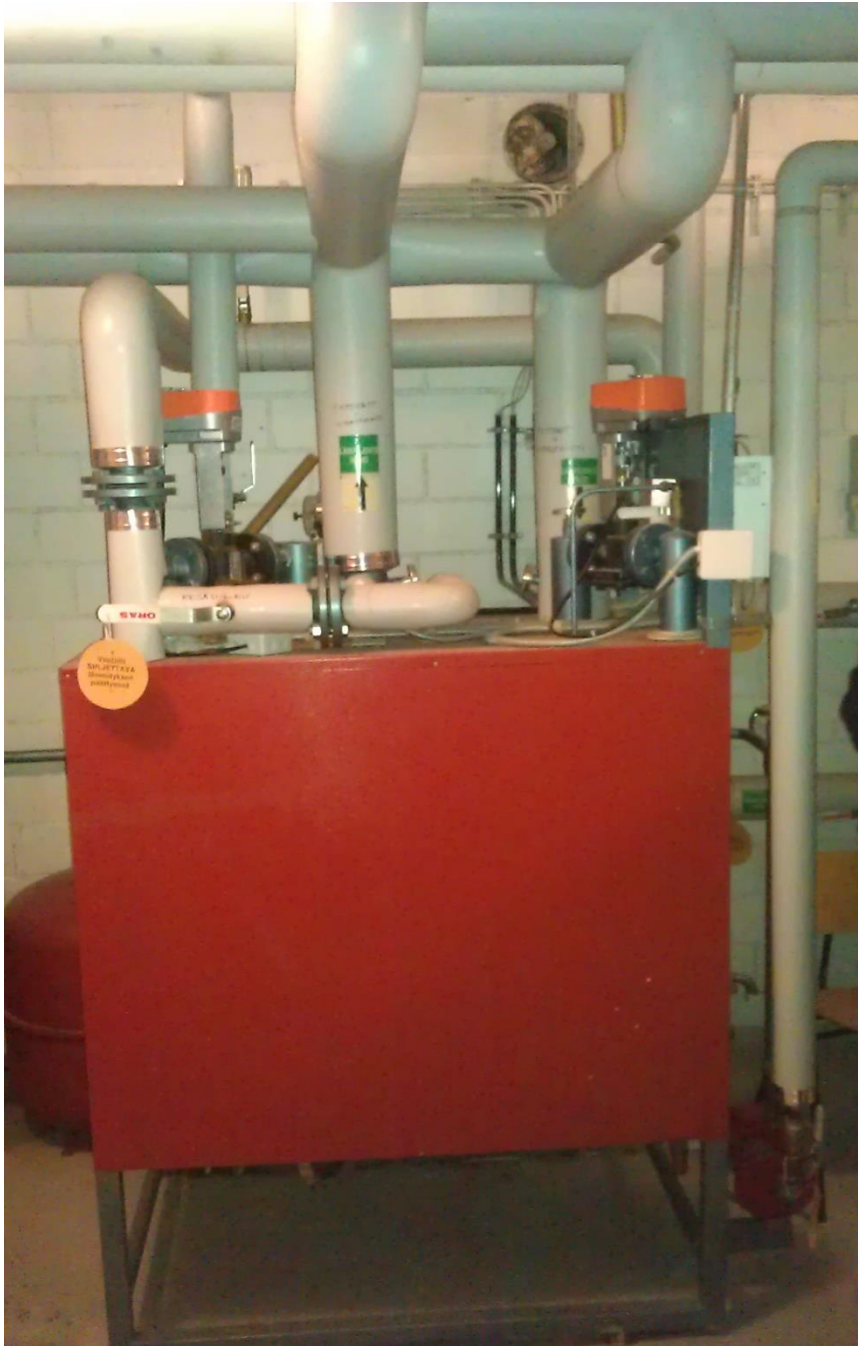
KUVA 9. Kaukolämmön alajakokeskus ja putkikytkentöjä (21.11.2012)
