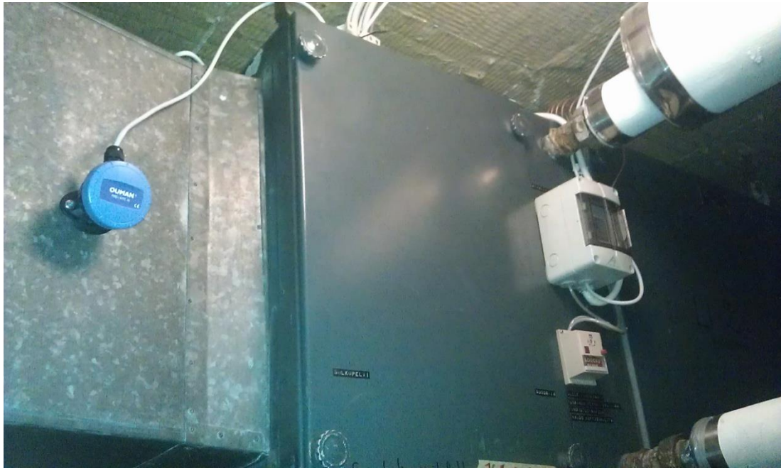
KUVA 11: Kellarikerroksessa sijaitseva IV-kone (21.11.2012)
