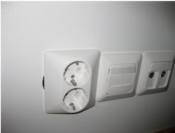
KUVA 12. Seinän liian suuri aukko pistorasialle
