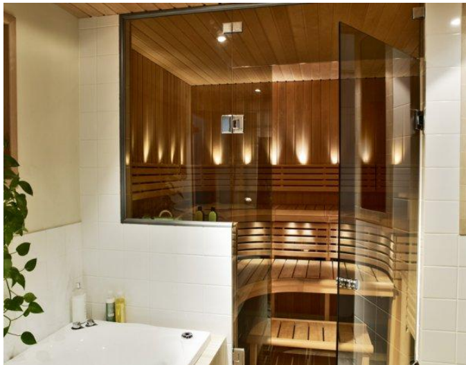
KUVA 3. Sunsaunan suunnittelema lauteisiin integroitu kuituvalaistus (23)
