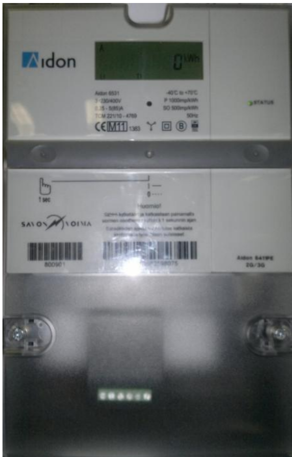
KUVA 1. Aidon 6531- etäluettava sähkömittari (Teemu Lappalainen, 2012)
