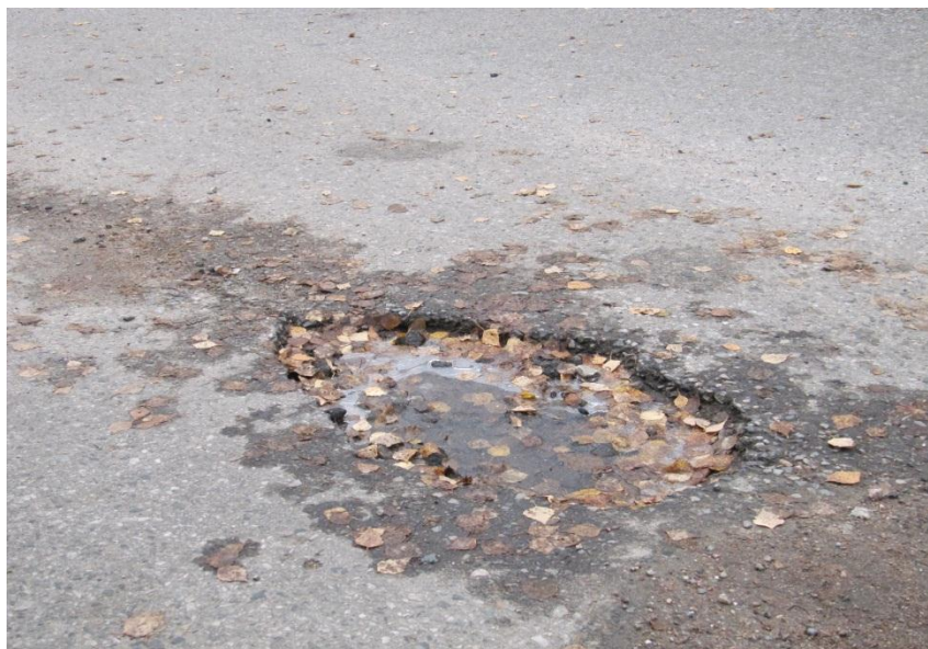
Kuvio 20. Päällystevaurio, reikä
