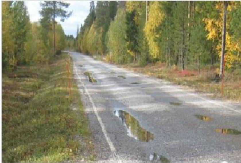
Kuvio 13. Pahoin urautunut päällystetty tie (Roadex Implementing Accessibility 2001–2011b)
