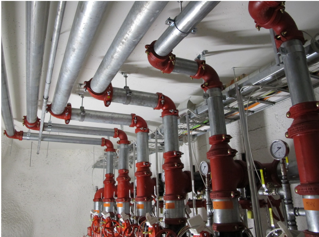
KUVA 8. Sprinklauskeskus ja varolaitteet
