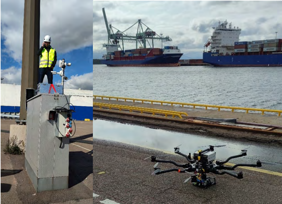
Kuva 3. 5G-testialueella sijaitsevan 5G-testijärjestelmän asennus Mussalon satamassa ja mittauksessa käytetty drone, johon kiinnitettynä Rohde & Schwarz testilaitteet 5G-peittoaluekartoitusta varten. Lähde: Vesa Vuorio.
