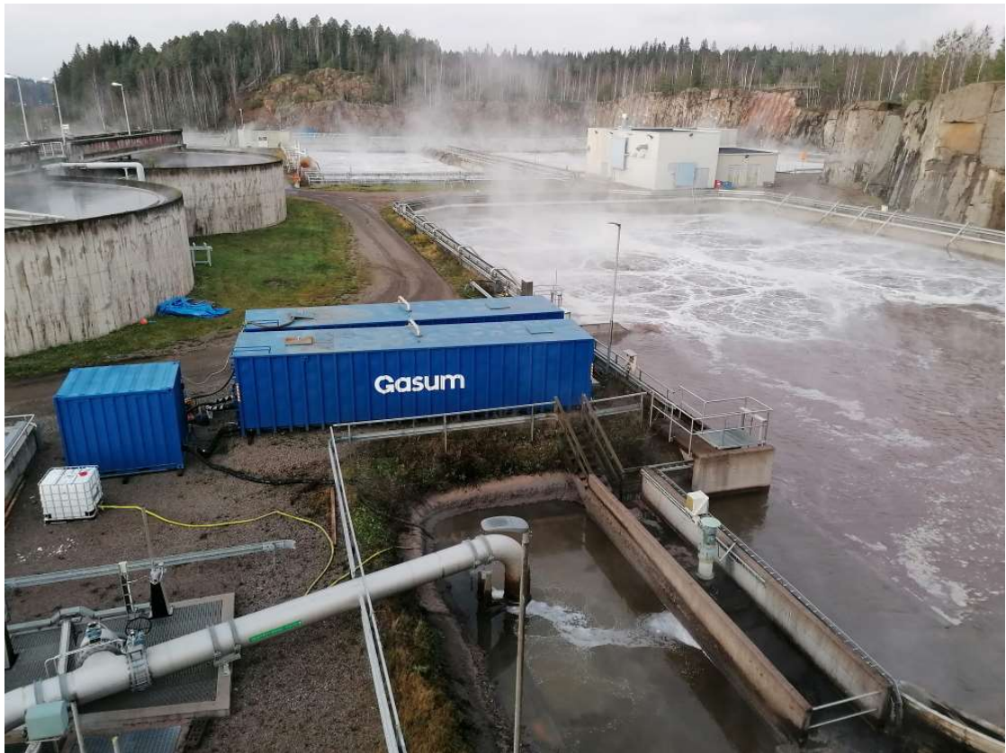
Kuva 2. Koeajon aikana käytetyt rejektivesikontit. Rejektivesi annosteltiin etualalla näkyvään neutralointialtaaseen, josta se kulkeutui esi-ilmastukseen ja takana näkyviin ilmastusaltaisiin.
