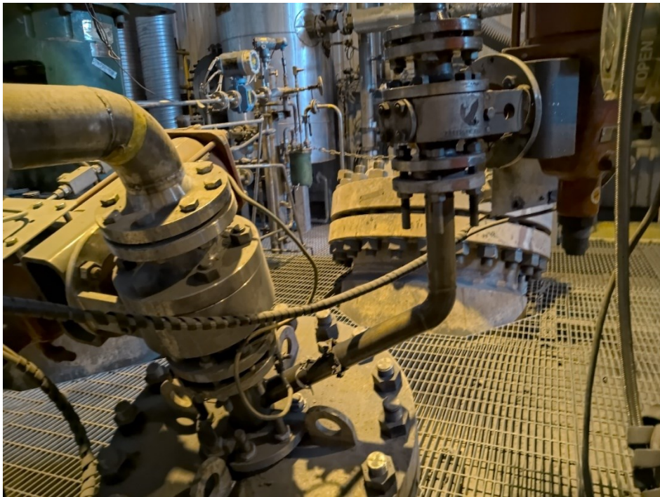
Kuva 4 Hapen syöttölinja ja huuhtelulinjan haara
