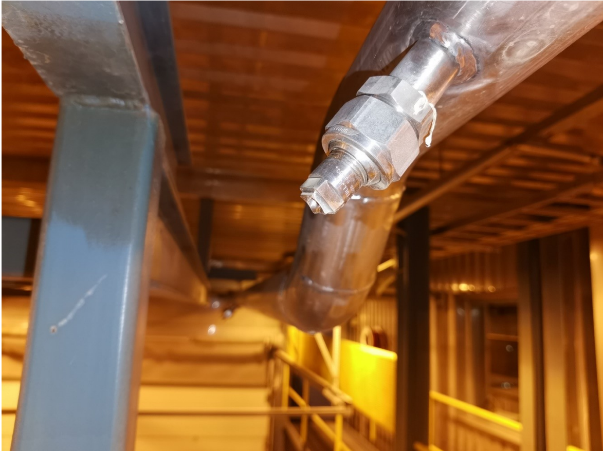
Kuva 22. Purkuaseman peittosuihkujärjestelmä on toteutettu fulljet-tyyppisillä suuttimilla.
