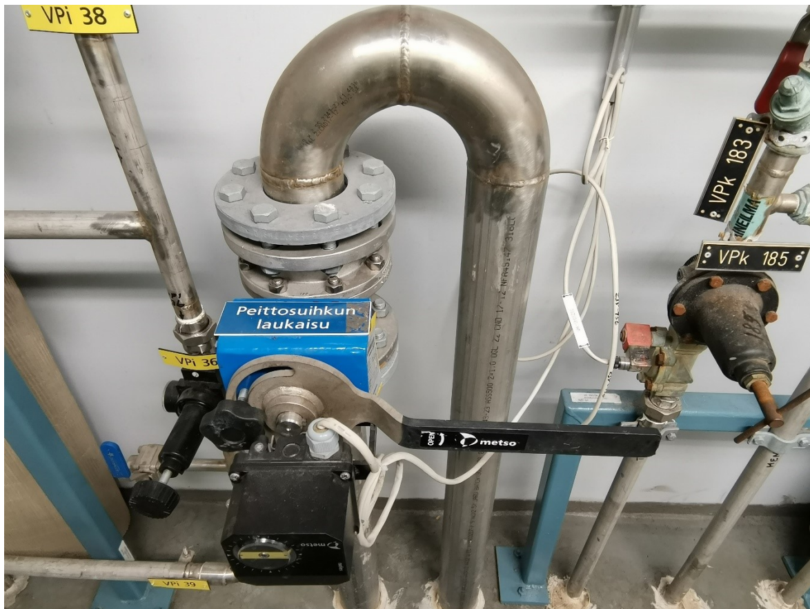
Kuva 20. Haponpurkuaseman peittosuihkun laukaisujärjestelyt.
