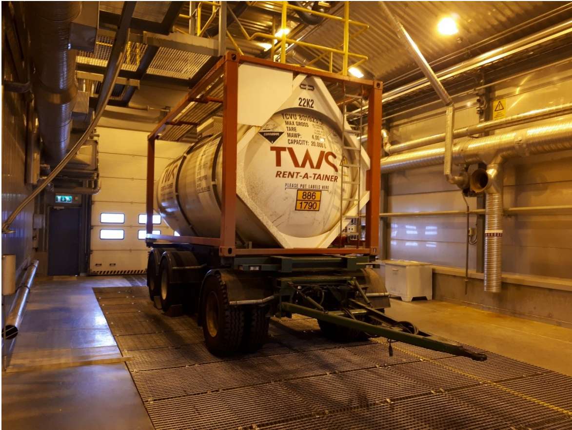
Kuva 17. Purkuasemalla säilytettävän kontin varoallas- ja turvajärjestelyt.
