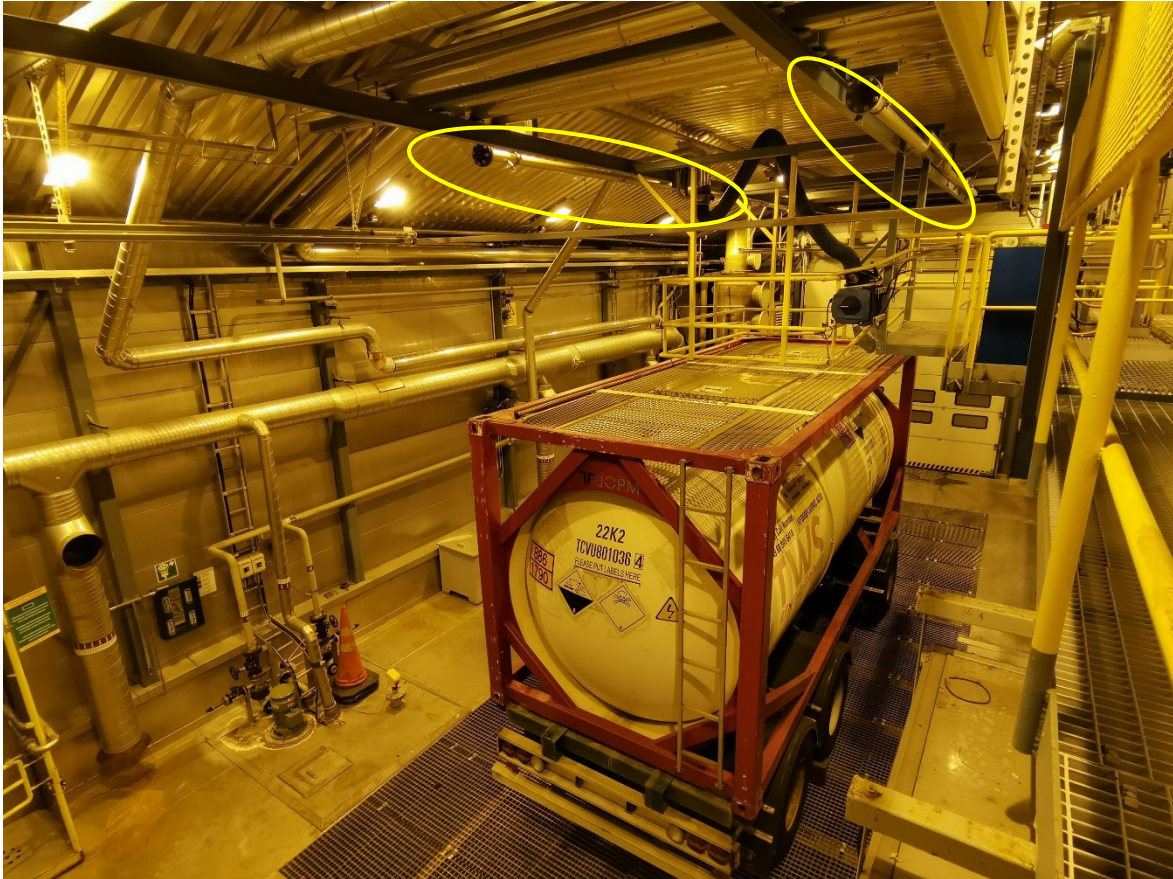
Kuva 21. Katonrajassa näkyvät kontin peittosuihkujärjestelmän putkistot.
