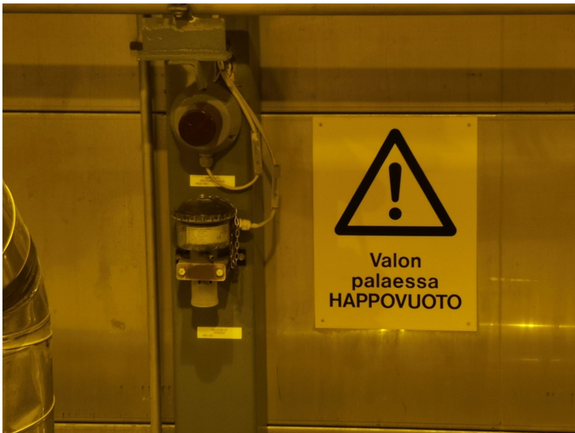
Kuva 19. Vuotokaasun pitoisuusmittaus varoitusvalolla ja vaarasta ilmaisevalla kyltillä.
