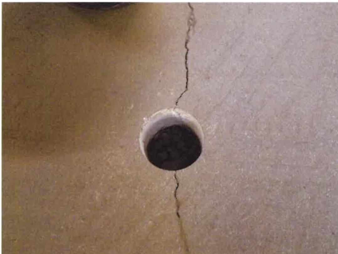
Kuva 13. Kuvassa on poralieriönäyte otettu betonilattian halkeaman kohdalta (YIT Suomi Oy, 2020).
