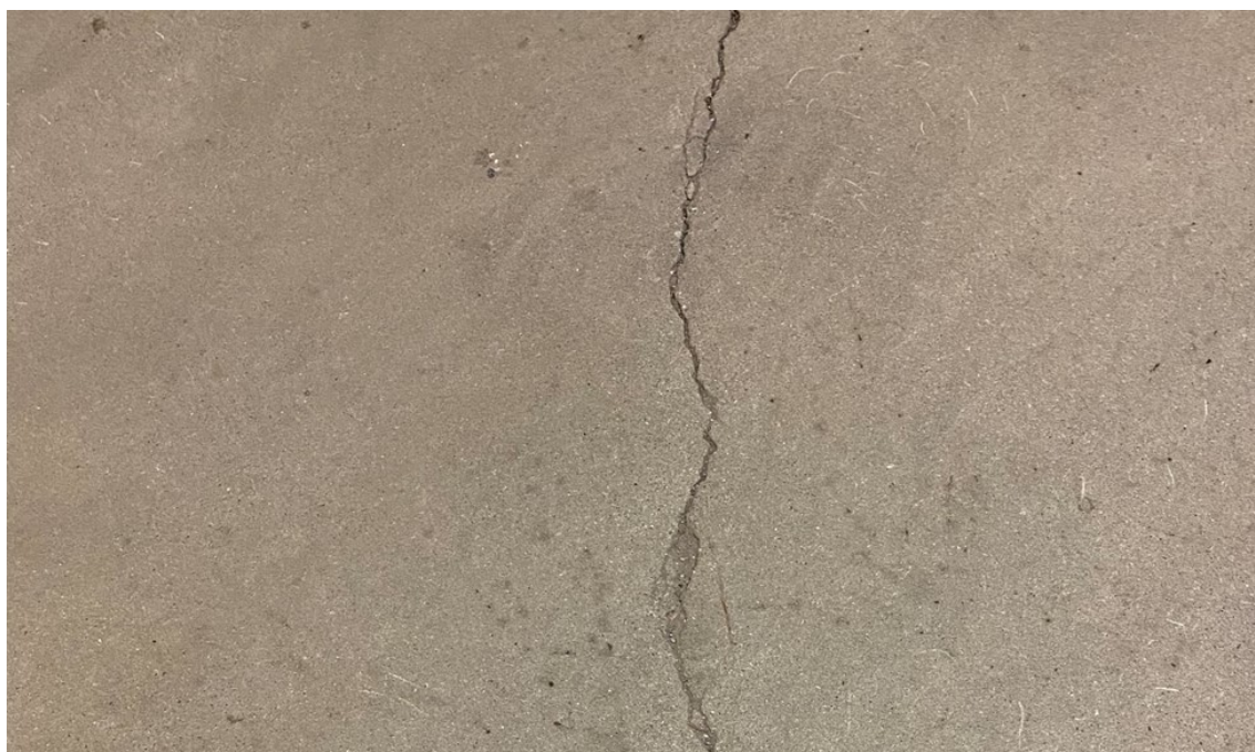
Kuva 11. Pysäköintihallin betonilattian halkeama (YIT Suomi Oy, 2020).
