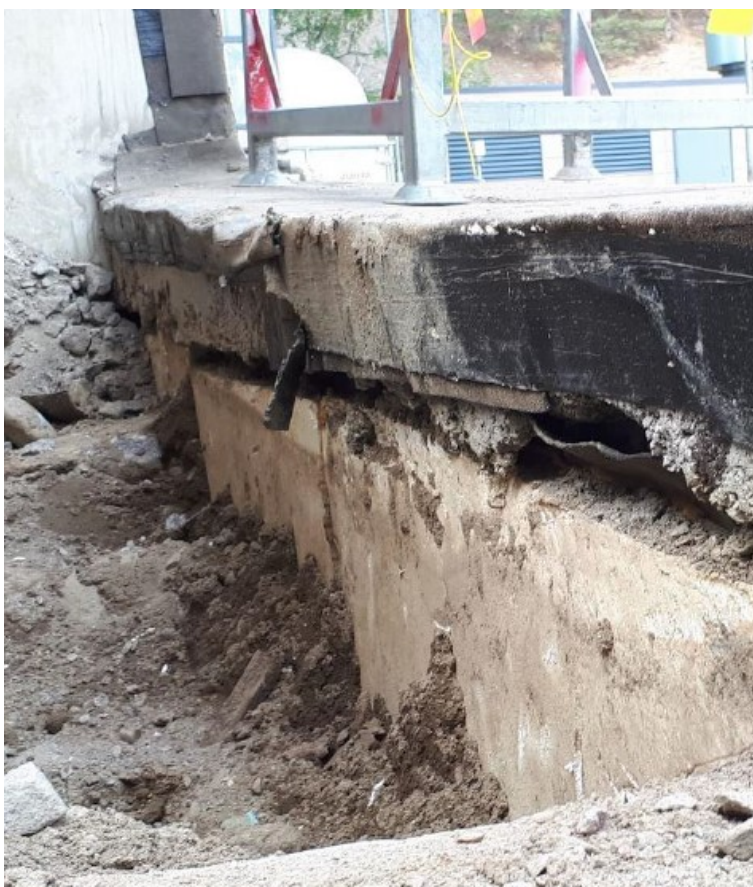
Kuva 10. Kuvassa kannen ja seinän välisestä liitoskohdasta päässyt sadevettä pysäköintihalliin (YIT Suomi Oy, 2020).
