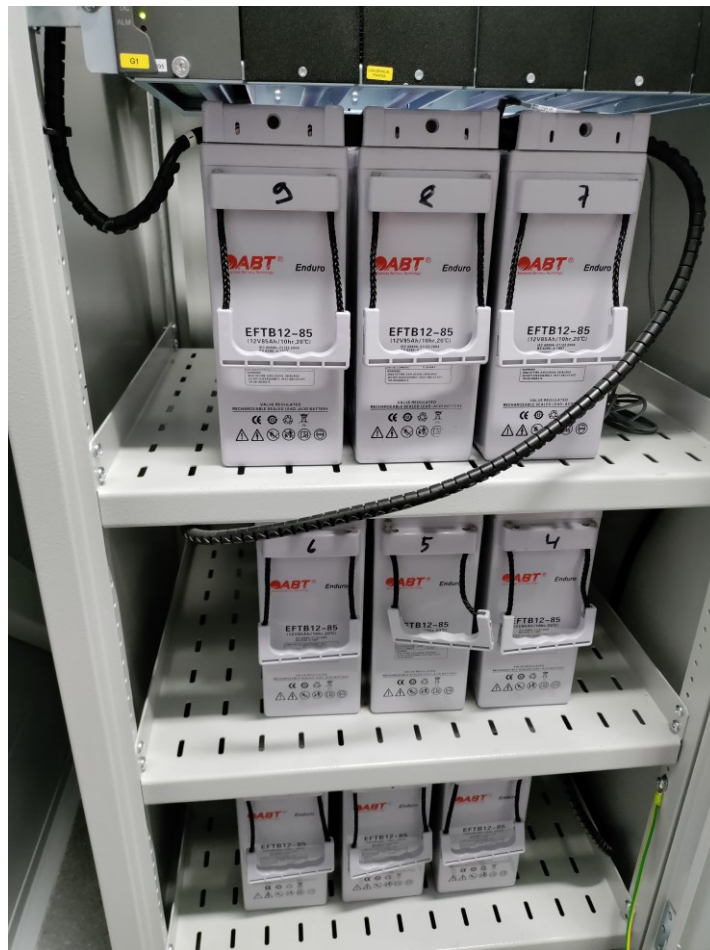
Kuva 3. Keskijännitekojeiston 110 VDC apusähköjärjestelmän akusto.
