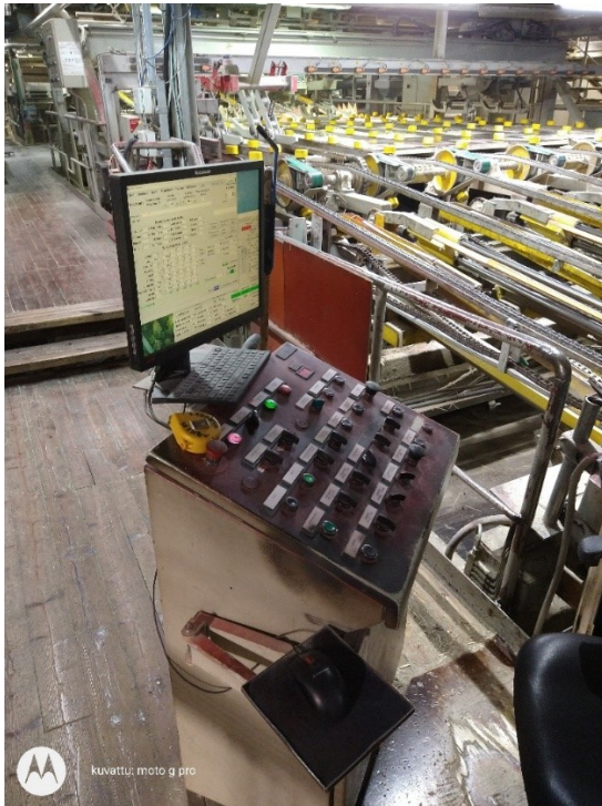
Kuva 15. Tuotantolaitoksen kenttäohjauspaikka, joita on tarkoitus suojata ups-järjestelmällä. (Janne Kuusikorpi 2021)
