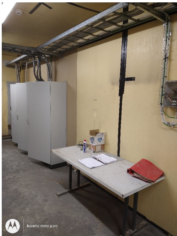
Kuva 16. UPS-järjestelmän tuleva sijoituspaikka, joka sisältää keskuksen ja laitteiston. (Janne Kuusikorpi 2021)
