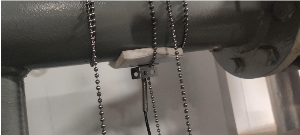
Figur 11. Temperatursensor monterad på röret.
