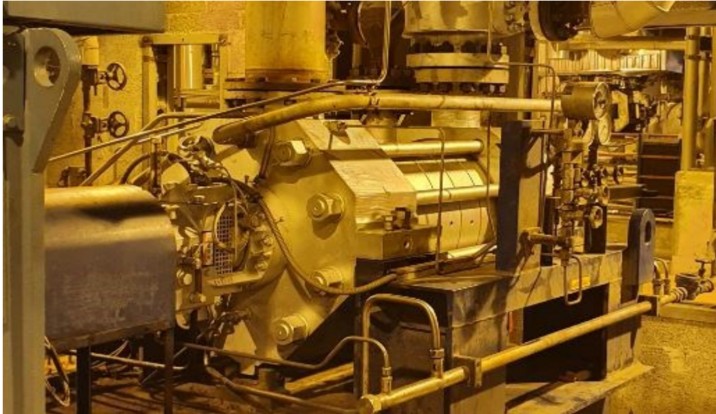
Kuva 6 Voimalaitoksella oleva pumppu.
