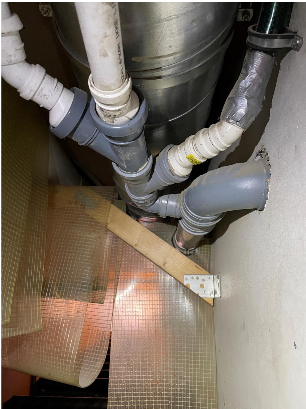
Puutteellinen viemäroinnin liitos
