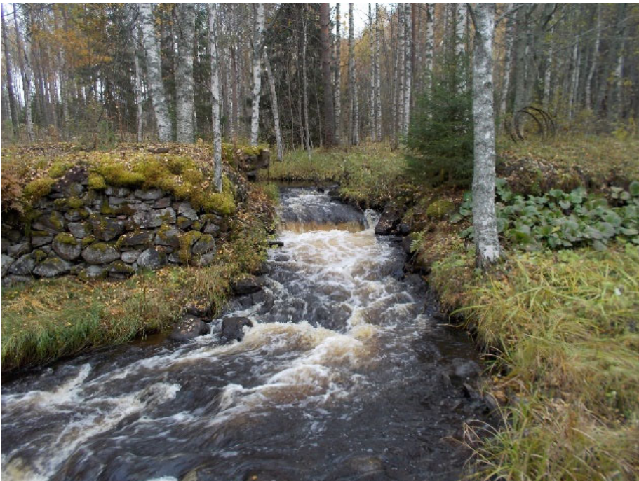
Kuva 30. Raunioituneet myllyn rakenteet Jukajoen Myllylän havaintopaikalla 51 07.10.2019. Kuvanoton jälkeen jokiuomassa olevaa kynnystä on porrastettu taimenen kululle soveliaaksi.
