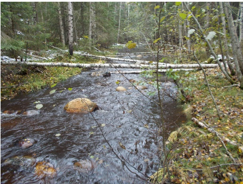
Kuva 28. Kalastolle kunnostettua Jukajoen yläjuoksun koskialuetta välittömästi kunnostustöiden jälkeen 7.10.2019. Aikoinaan uittoa varten perattuun uomaan on pääosin konetyönä siirretty asentokiviä ja kivi- + puusuisteita.
