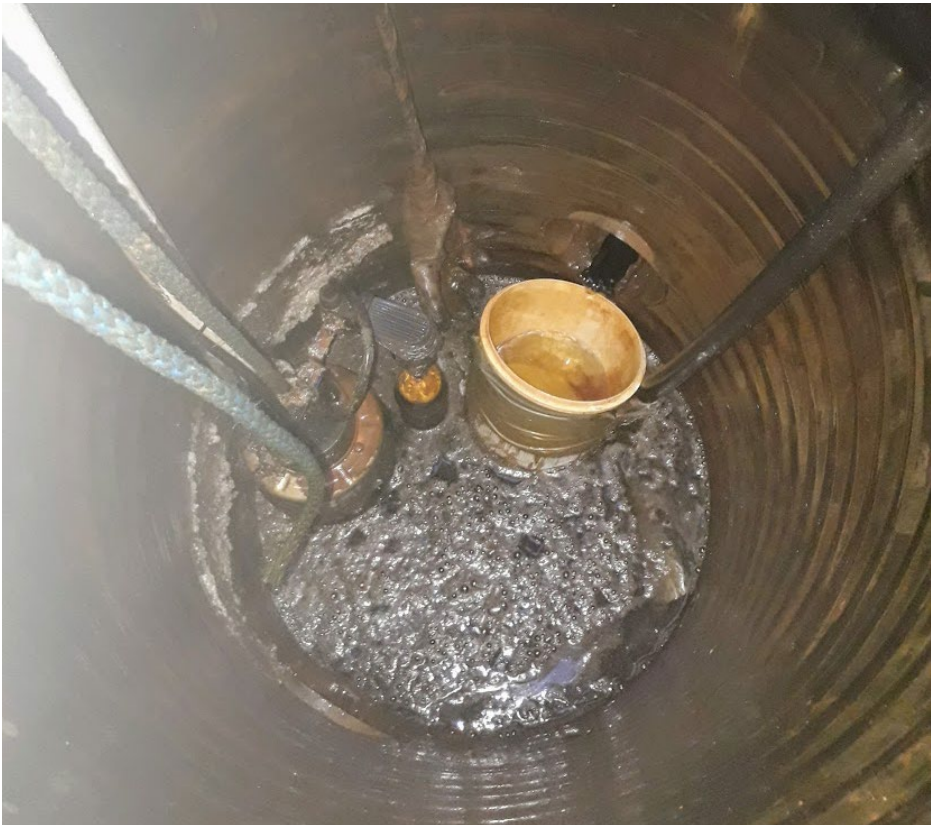
KUVA 1. Suotovesikaivon tulovesiputkesta tehtävä virtaaman astiamittaus. Jatkovarren päässä olevaa ämpäriä on erittäin vaikea pitää luotettavasti paikoillaan, jolloin virtaamamittauksissa esiintyy helposti mittausvirhettä (kuva Aki Mykkänen).
