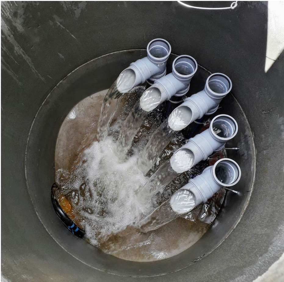
KUVA 5. Pitkäjärven suodatinjärjestelmän kokoojakaivossa vuonna 2020 asennetut korotetut suodatinkaivojen poistoputkien suuttimet. Suuttimien avulla vedenkorkeus suodatinkaivoissa kasvoi niin, että suodatinmateriaalit ovat virtaamasta riippumatta veden alla (Kuva Aki Mykkänen).
