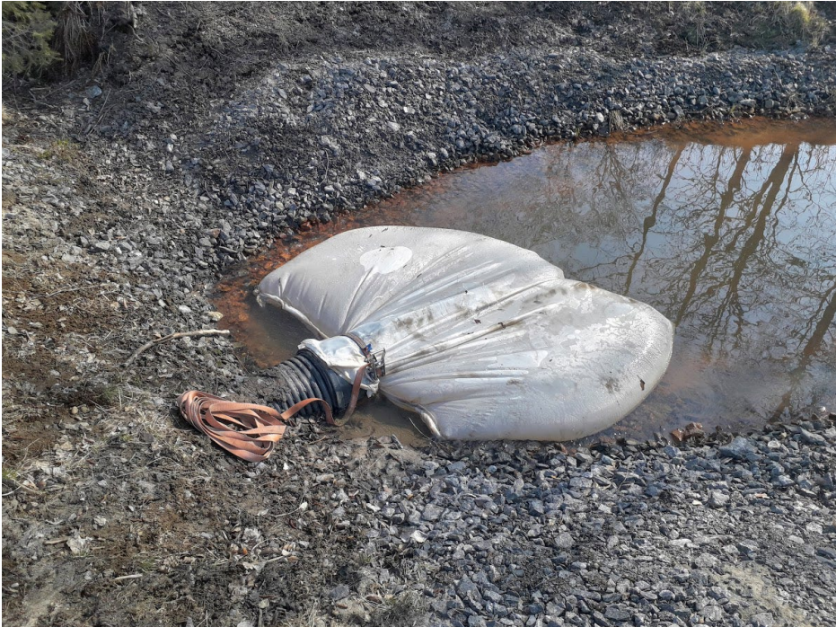
KUVA 9. Pitkäjärven hulevesijärjestelmän poistoputkelle muutostöiden 2020 ajaksi asennettu siltikangaspussi, jolla kerättiin järjestelmästä irtoavaa biohiilipölyä. Pussi poistettiin muutostöiden päätyttyä (Kuva Aki Mykkänen).
