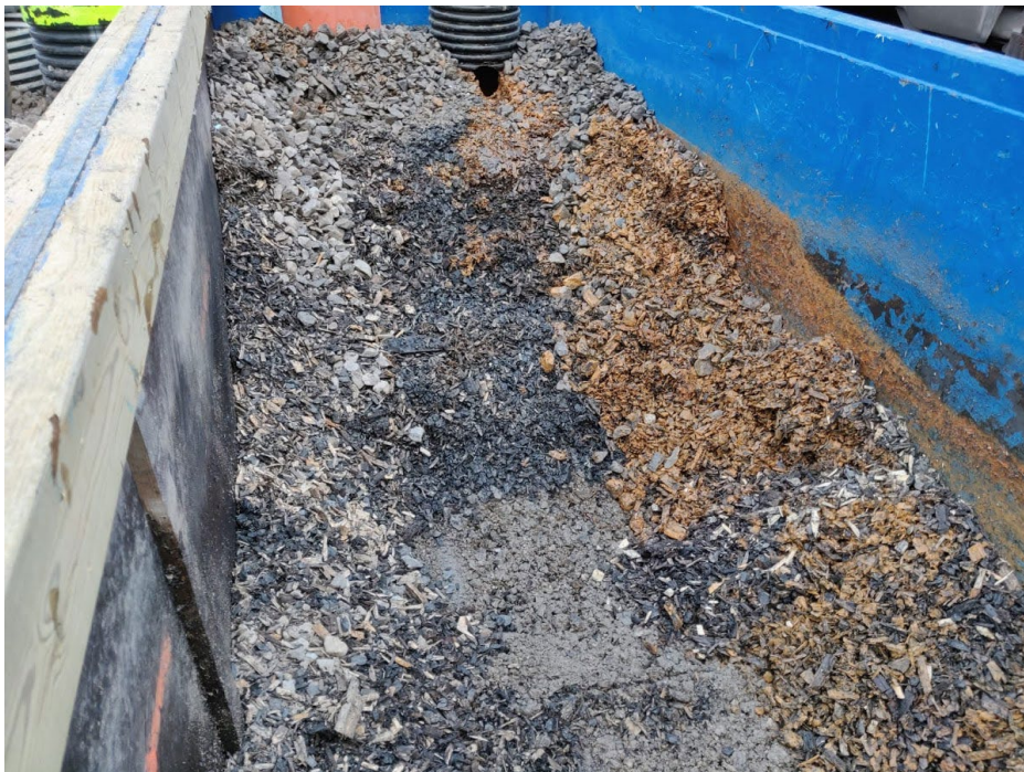
KUVA 11. Suodatinpatjassa näkyvä rautasakka järjestelmän tyhjennyksen aikana marraskuussa 2020 (kuva Lasse Hämäläinen).
