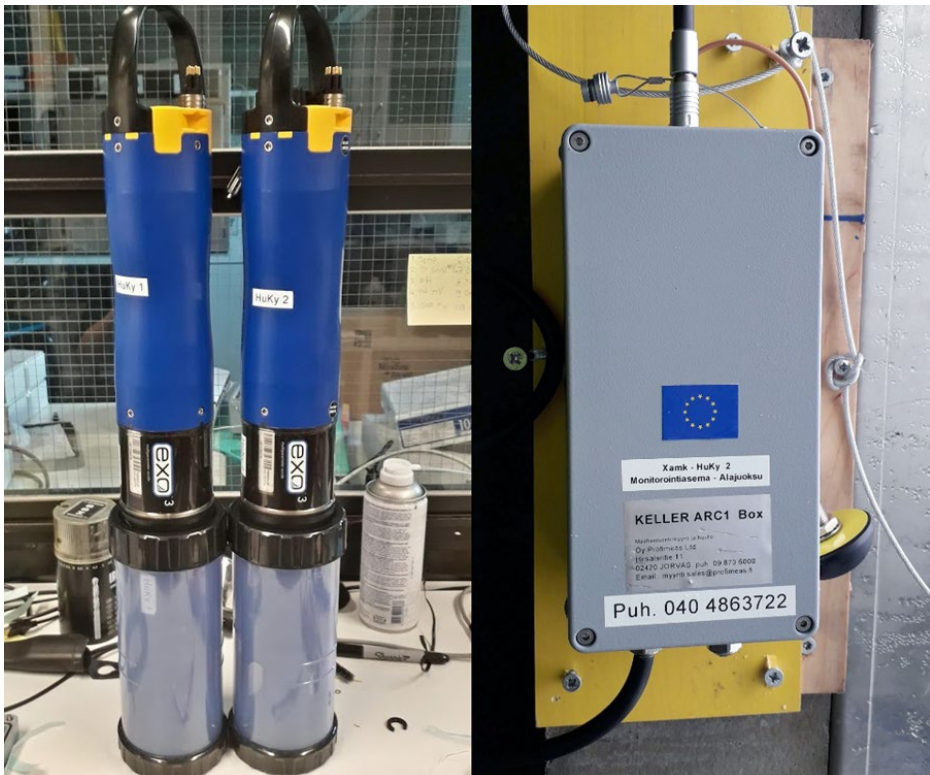
KUVA 8. EXO 3 -vedenlaatusondit (vasen) sekä ARC-1-lähetynyksiköt (oikea). Laitteiden välillä on 10 metriä pitkä datakaapeli (Kuva Aki Mykkänen).
