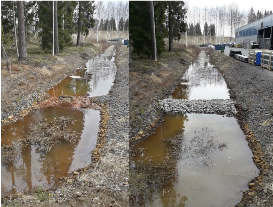
KUVA 3. Suotopato ennen (vasen) korjauksia ja niiden jälkeen (oikea) vuoden 2020 muutostöiden yhteydessä. Talven jäljiltä pato on romahtanut ja vesi virtaa patorakenteiden yli. Patojen rakenteet uusittiin muun muassa suurentamalla kivikokoa, jolloin rakenteet pysyvät paremmin yhdessä (Kuva Aki Mykkänen).
