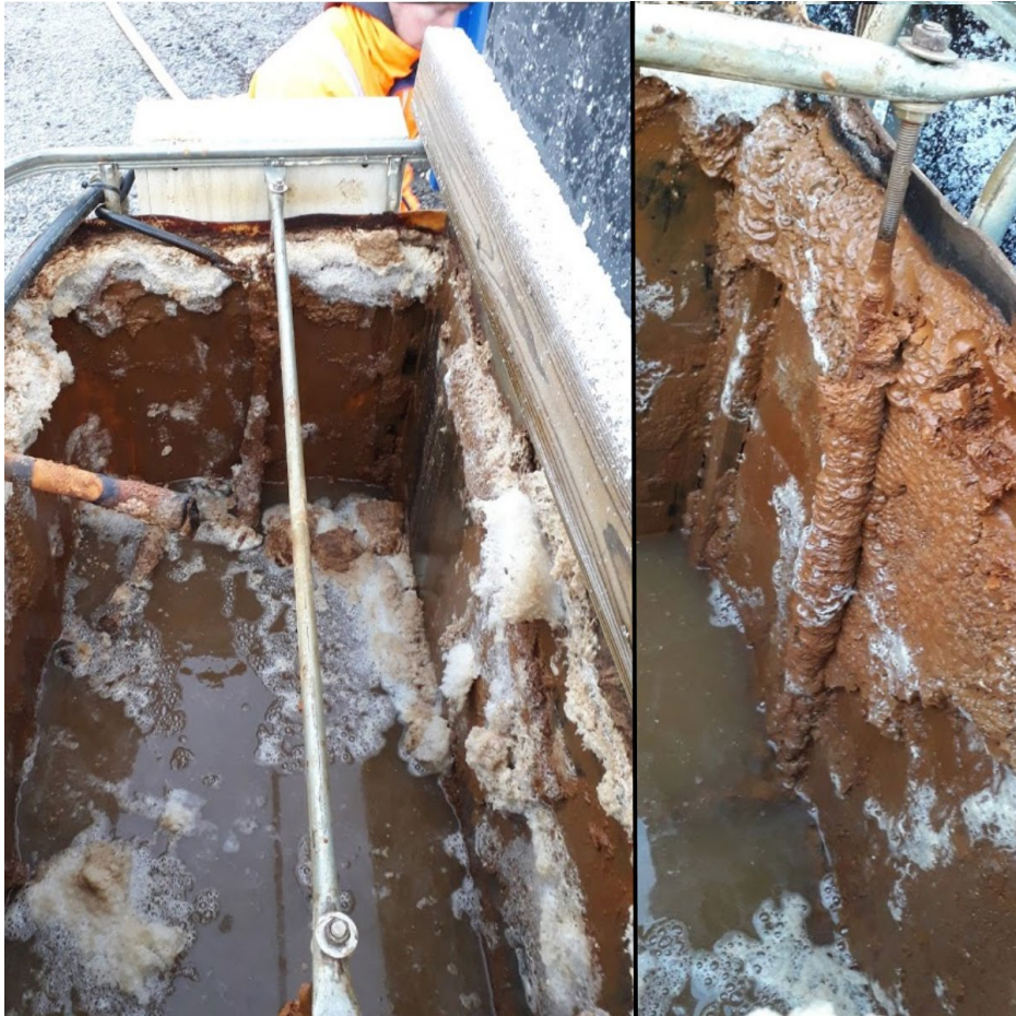
KUVA 11. Ilmastusaltaassa havaitut sakkamäärät sekä niiden pinttyminen altaan reunoille ja hapettimen kiinnittimiin (kuvat Aki Mykkänen).
