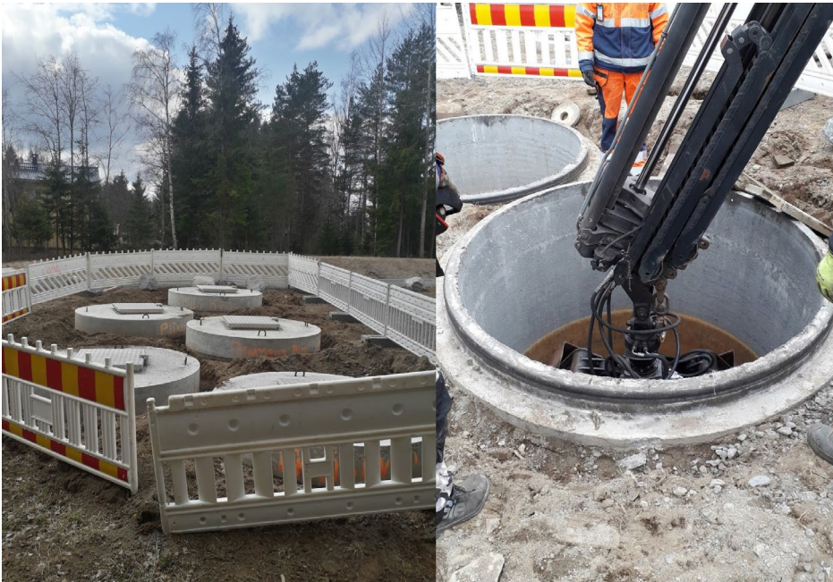
KUVA 2. Turvallisuuksyistä suodatinkaivot on aidattava huoltotöiden ajaksi. Huoltotöissä tarvitaan työkoneita kaivojen betonikansien ja suodatinmateriaalimassojen siirtämiseksi (kuva Aki Mykkänen).
