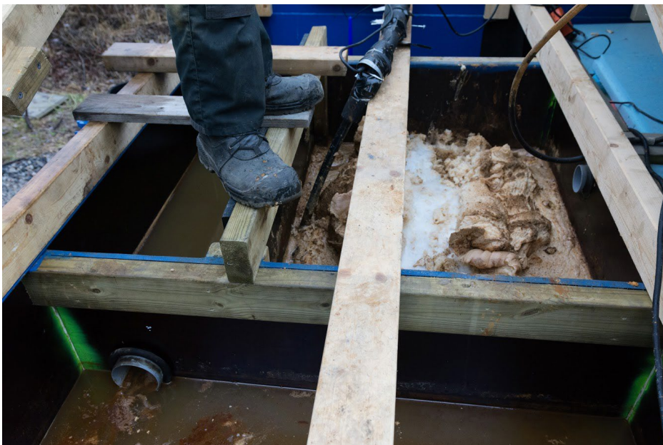
KUVA 16. Alkuperäisestä ilmastusaltaasta havaittavia, ilmastuksesta syntyviä vaahtokerrostumia (kuva Aki Mykkänen).
