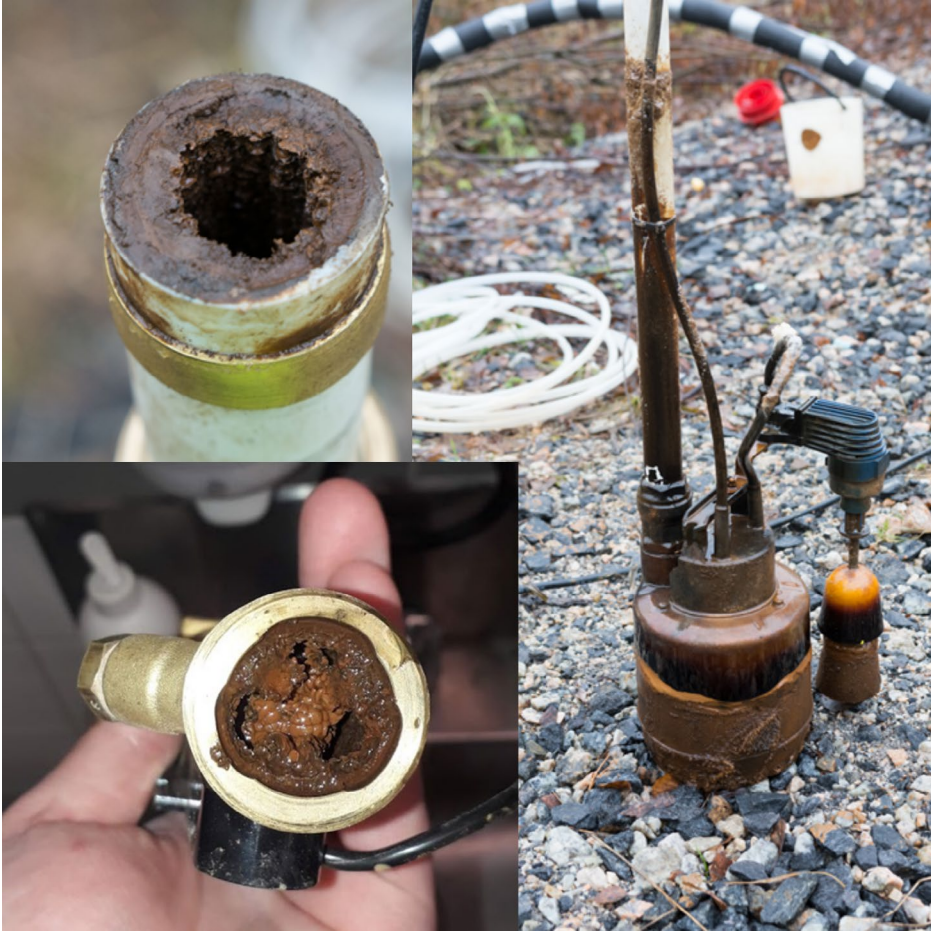
KUVA 5. Vuoden 2019 noin kolmen kuukauden jälkeisen toiminnan jälkiä. Vasemmalla ylhäällä tuloputken sisäpuoli, joka on pinttynyt rautasakalla alle puoleen halkaisijastaan. Vasemmalla alhaalla ultraäänivirtaamamittari, joka myös on sisältä vahvojen rautapinttymien peitossa. Oikealla tulopumppu, joka kolmen kuukauden käytön jälkeen on pinttynyt ruskeaksi ja käyttökelvottomaksi (kuvat Aki Mykkänen).
