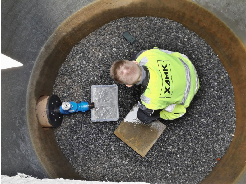
KUVA 6. Suodatinkaiivossa tehtävä tuloventtiilin säätäminen. Ennen muutostöitä kaivo oli täynnä vettä kaivon seinämällä näkyviin rajoihin asti (kuva Aki Mykkänen).
