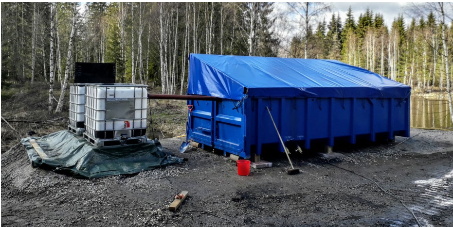
KUVA 8. Kevään 2020 muutostöiden jälkeinen Ristiinan vanhan kaatopaikan biosuodatuslaitteisto. Vasemmalla kaksi IBC-konteista tehtyä esiselkeytysallasta (kuva Aki Mykkänen).
