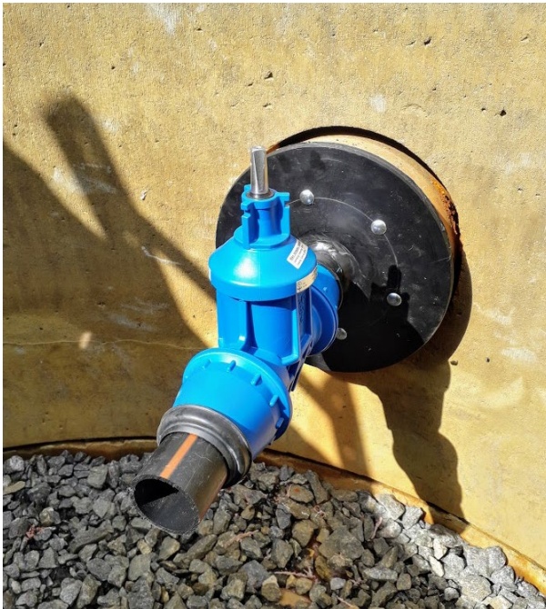
KUVA 4. Pitkäjärven suodatinjärjestelmän vuoden 2020 muutostöiden tuloksia. Suodatinkaivojen tuloveden säätöventtiili, josta tulovirtaamaa voidaan säädellä portaattomasti (kuva Aki Mykkänen).
