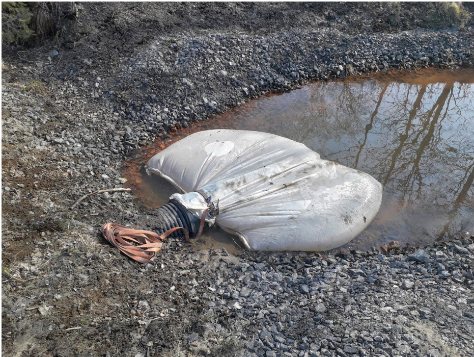
KUVA 5. Silttikankaasta tehty kerääjapussi järjestelmän poistoputkella. Pussilla saadaan kiinni huoltotöiden aikana irtoava lika ja roskat. Pussi poistetaan huoltotöiden jälkeen, koska se padottaa vettä merkittävästi (kuva Aki Mykkänen).
