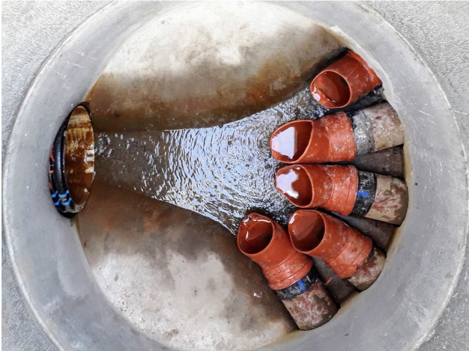
KUVA 3. Pitkäjärven suodatinjärjestelmän kokoojakaivossa vuonna 2019 käytössä olleet suodatinkaivojen poistoputkien suuttimet, joilla voitiin mahdollistaa virtaamamittaukset. Kaivon pohjalla näkyvä vesi samassa korossa poisto-ojan vedenpinnan kanssa (Kuva Aki Mykkänen).
