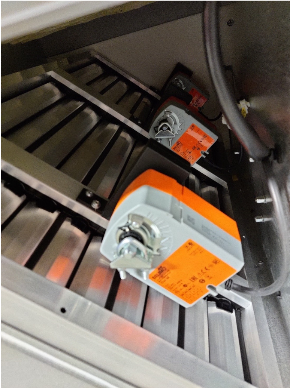
Kuva 10. Pureon lohkopellit ja peltien toimilaitteet. Etualalla myös ohituskanavan sulkupellit.
