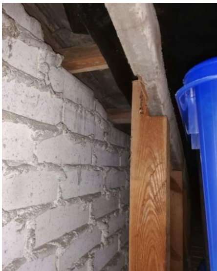
Kuva 1 Aluskatteet eivät ylitä seinälinjaa. Alkuperäisiä aluskatteita yritetty jatkaa muovisilla aluskatteilla. Tiilikate näkyy alapuolelta.
