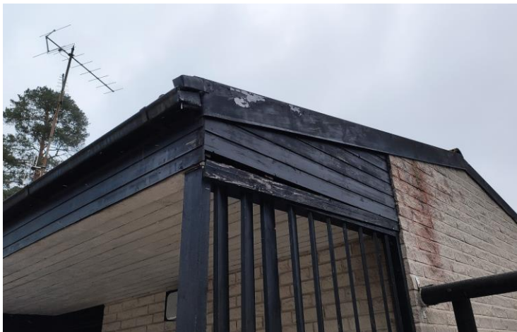
Kuva 5 Vaurioita päätypaneloinneissa ja tiilijulkisivussa.
