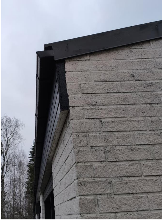
Kuva 4 Pohjoispuolen räystäiden ylitys vain n. 150 mm. Päädyissä ei ylitystä.
