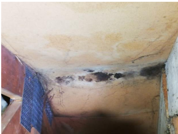
Kuva 3 Aluskatteissa havaittavissa mikrobikasvustoa.
