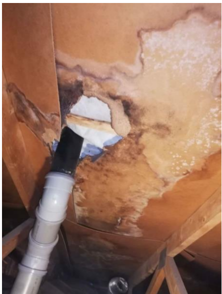
Kuva 2 Kosteuden aiheuttamia vaurioita läpiviennin kohdalla.
