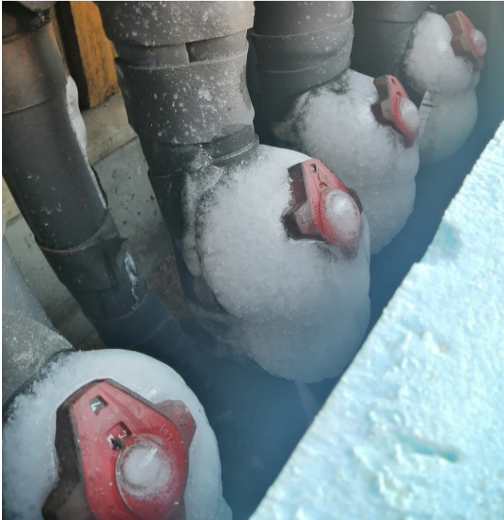
Kuva 5. Jakotukin linjasäätöventtiileihin kerääntyy kondenssivettä, joka jäätyy venttiilin runkoon, koska menopuolen liuos on pakkasen puolella.
