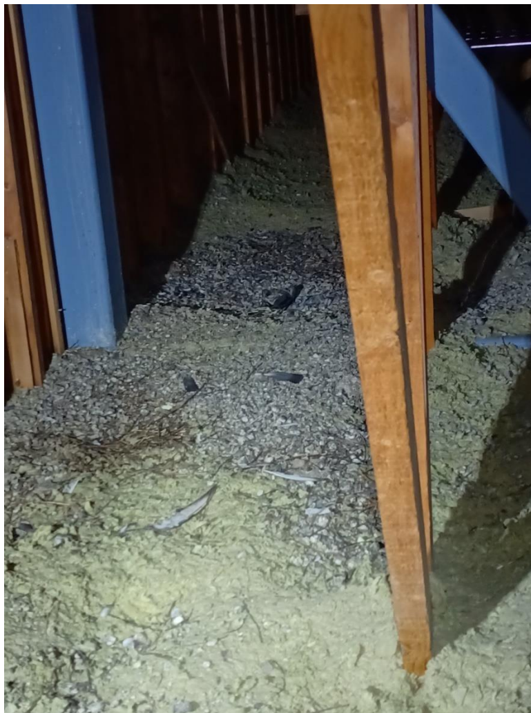
Kuva 8. Lintujen pesiä yläpohjassa (Ridanpää 2021)
