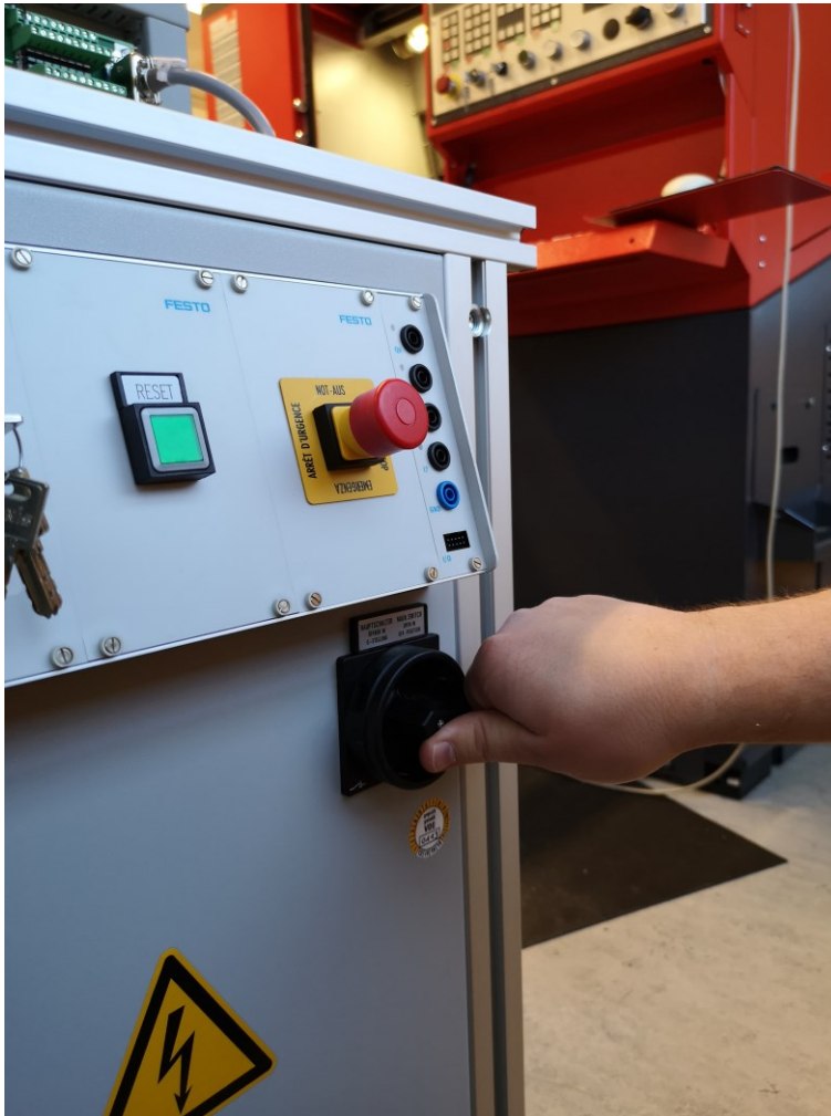
Kuva 3. Koneistussolun robottiaseman päävirtakytkin
