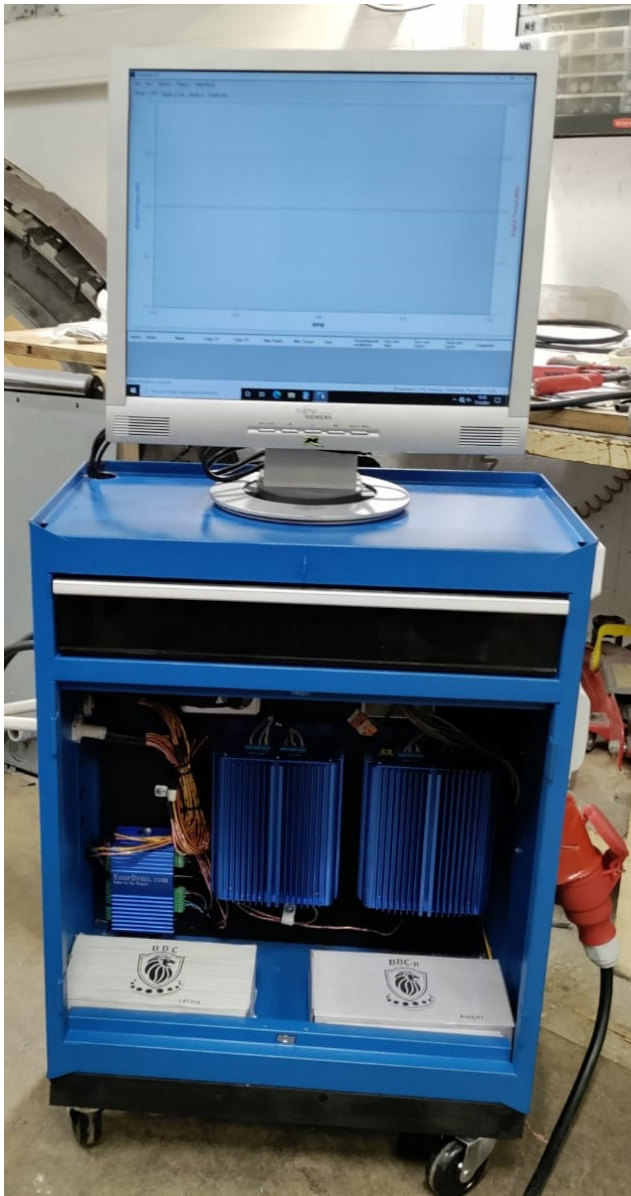
KUVA 30. Ohjauskaappi ilman ovia
