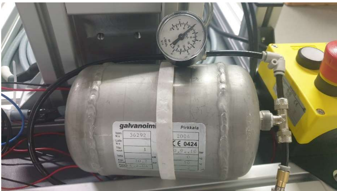
Kuva 33. Painesäiliö ja sen painemittari.
