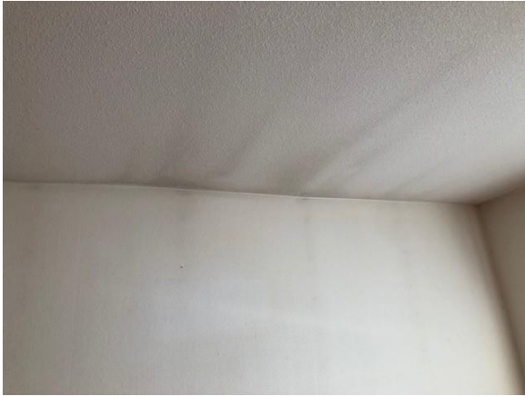
KUVA 2. Ilmavuodosta johtuvat vauriot yläpohjan ja seinän liittymäkohdassa
