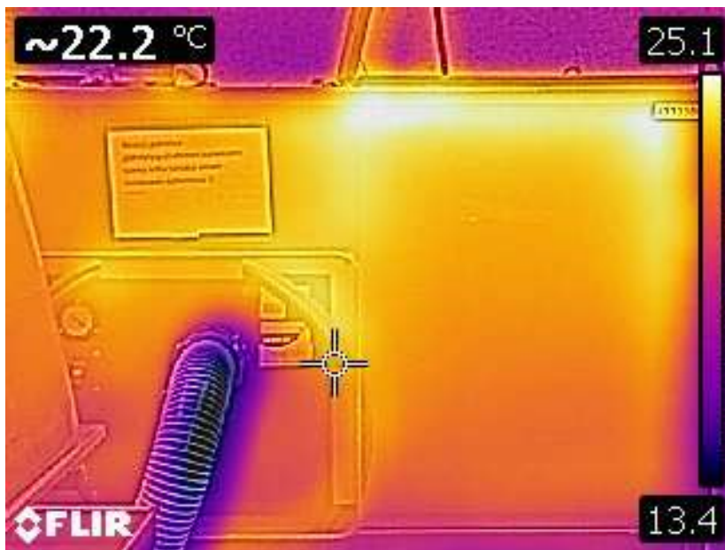
Kuva 3. Lämpökamerakuva laittilaan sijoitetusta jäähdytyspuhaltimesta huoltotyön alkaessa
