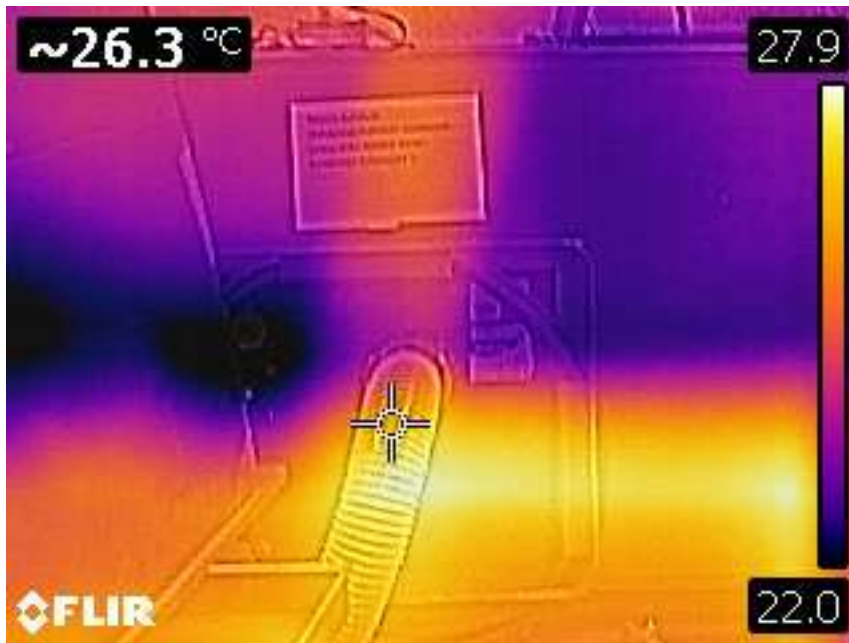
Kuva 4. Lämpökamerakuva laitetilaan sijoitetusta jäähdytyspuhaltimesta huoltotyön loppuessa.
