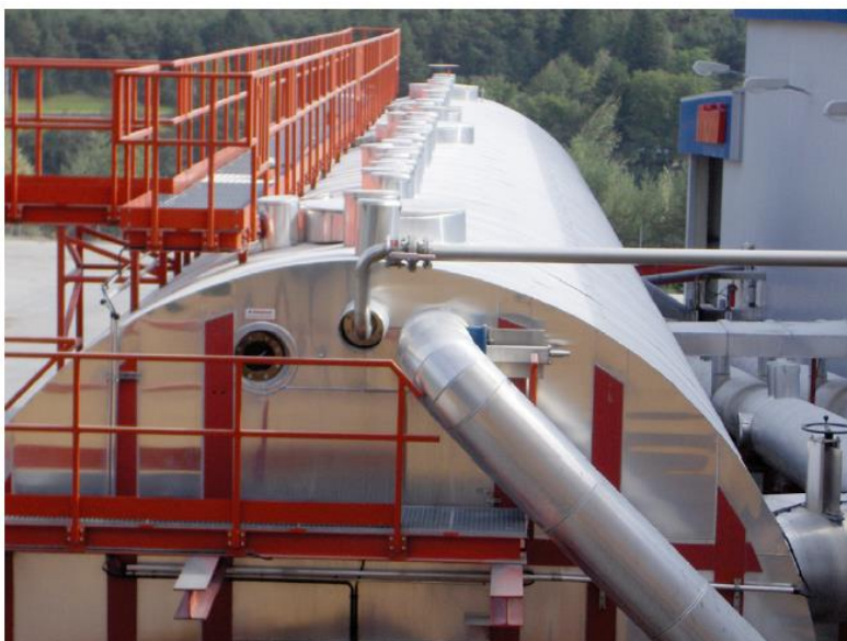
Kuva 2. Tulppavirtausreaktori, joka sijaitsee Thonissä Itävallassa (Paavola 2015, 86)
