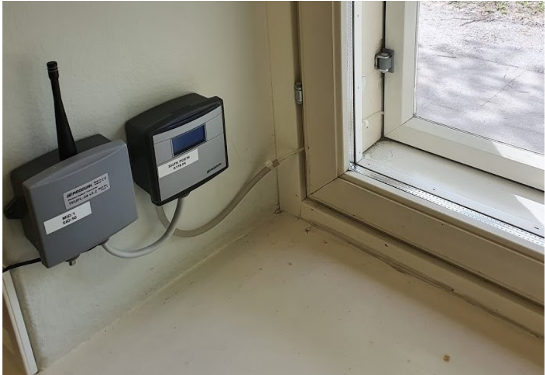
Kuva 27. Kiinteästi asennettu vertailumittaus
