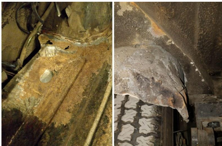
Kuva 8. Ajoneuvon ruostevaurioitunut runko ja repeytynyt runkopalkki.
