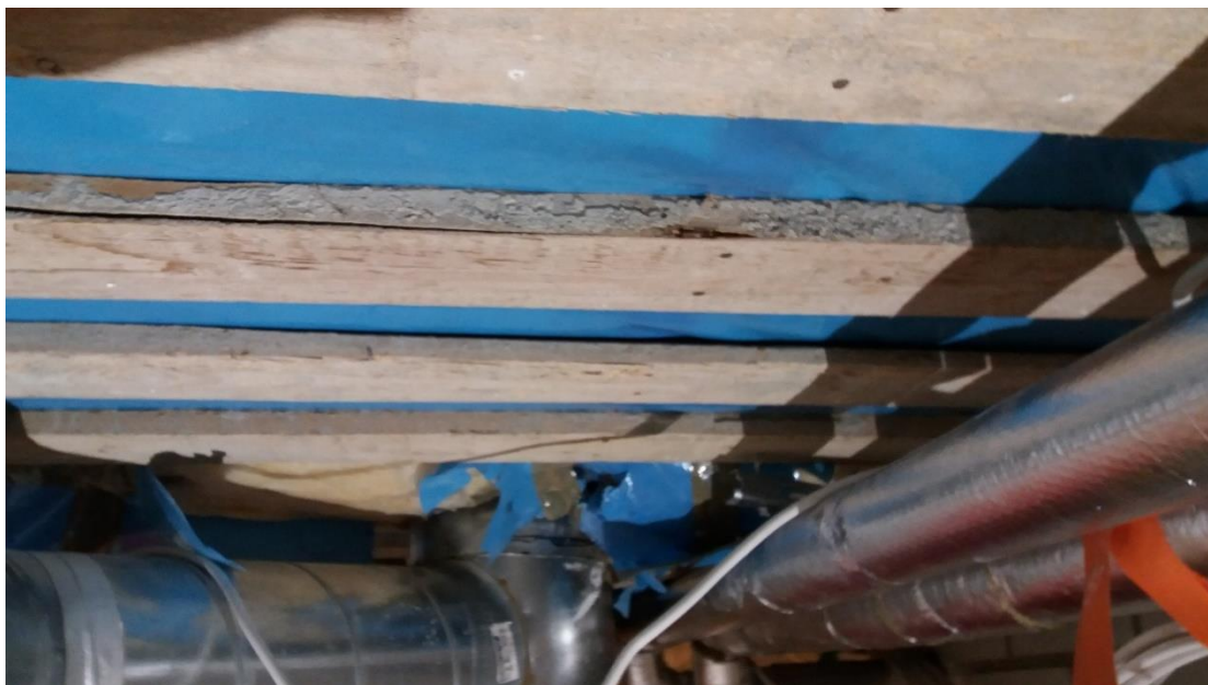
Kuva 3. Esimerkki yläpohjan ilman- ja höyrynsulkuna toimivan muovikalvon rikkoutumista, yläpohjan lasivillaeriste on paljaana laajalta alueelta. Kuva ei liity tässä tutkimuksessa olleisiin rakennuksiin, kyseinen 1970-luvulla rakennettu yksikerroksinen palvelurakennus on jo purettu (Kuva: T. Jarva).
