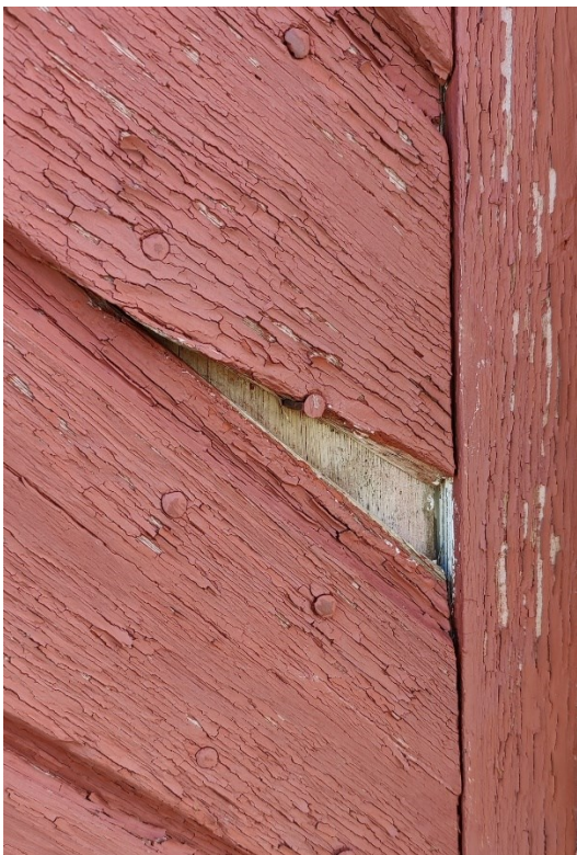
Figur 60 Bit av dörrpanelen saknas (101.1) (Isaksson 2021)
