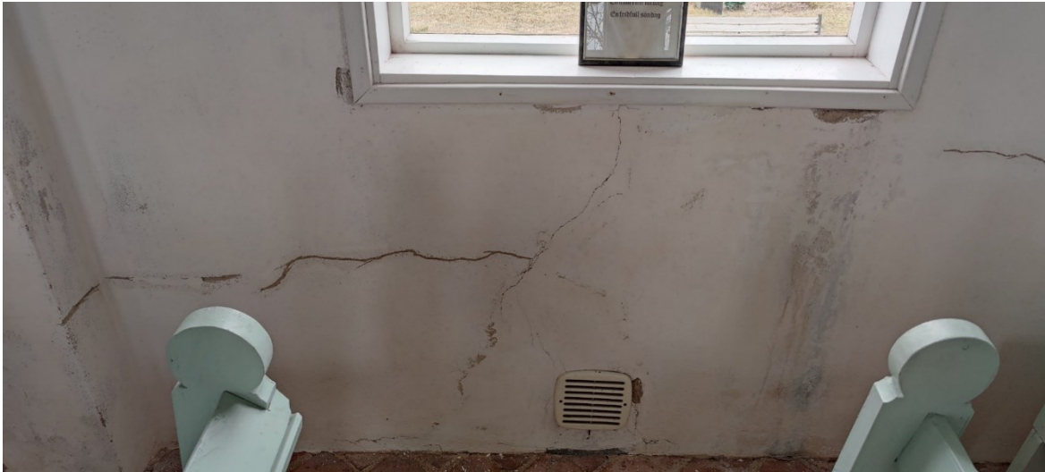
Figur 69 Sprickbildning i mitten av södra väggen (Isaksson 2021)
