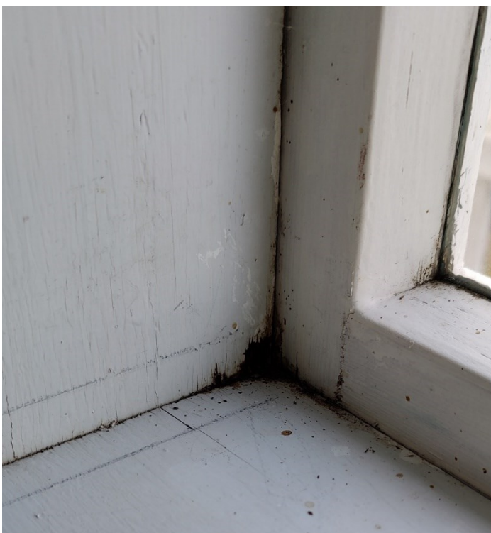
Figur 87 Fuktskada i fönsterkarmen på norra väggen (Isaksson 2021)
