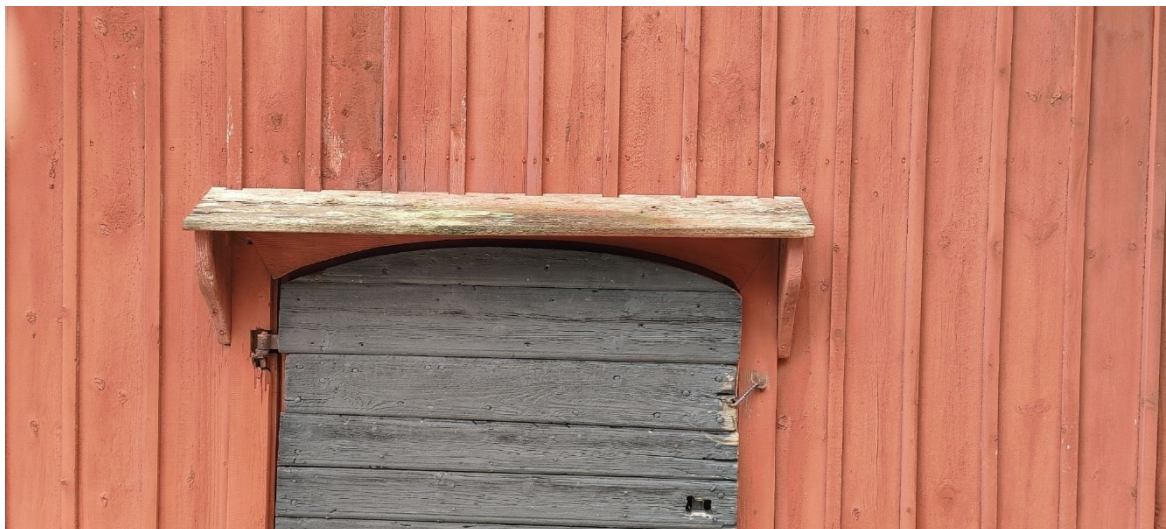
Figur 14 Vattbrädet ovanför dörr fuktskadat. (Isaksson 2021)
