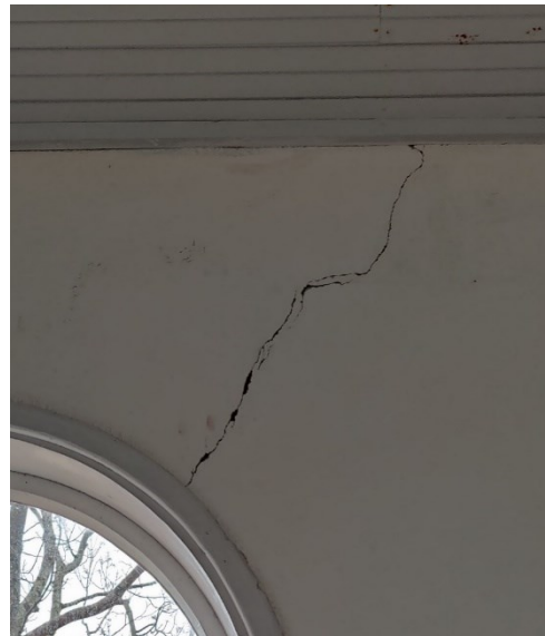
Figur 44 Samma spricka går genom hela väggen (Isaksson 2021)
