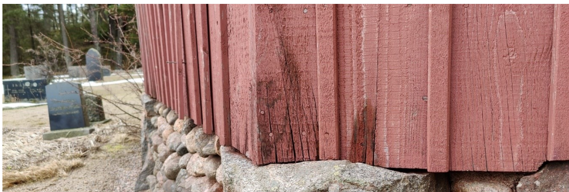
Figur 17 Fukt i brädfodringen intill grund och lösa locklister (Isaksson 2021)
