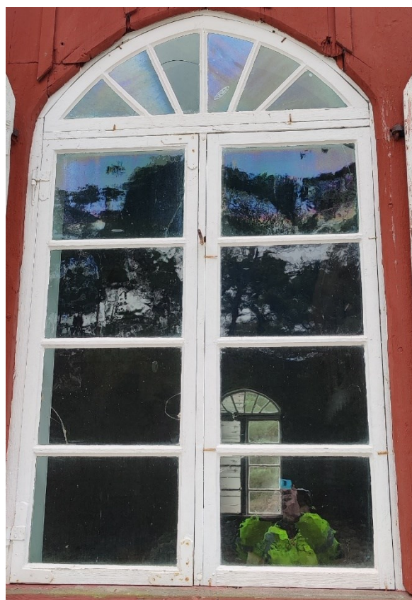
Figur 30 Rutor spruckna på fönster 1102 (Isaksson 2021)
