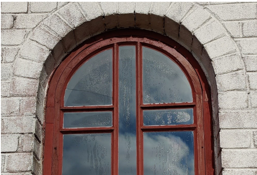
Figur 55 Spricka i fönster nr.201 (Isaksson 2021)
