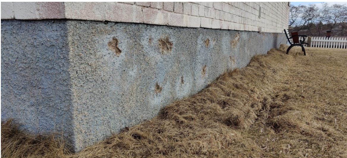
Figur 39 Skador i rappningen på södra sidan (Isaksson 2021)
