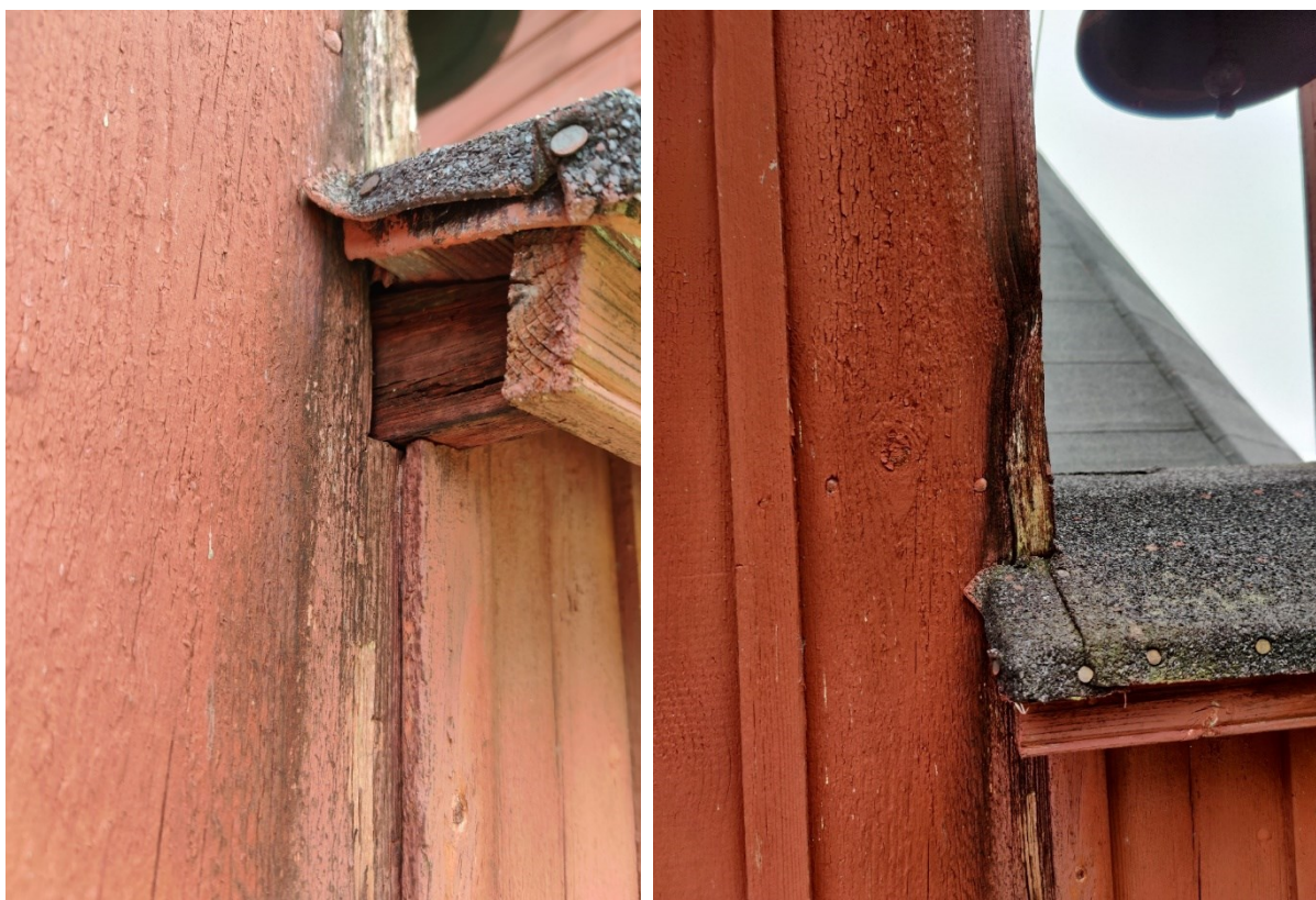
Figur 12 och 13 Fuktskada vid klocktorns konstruktion (Isaksson 2021)
