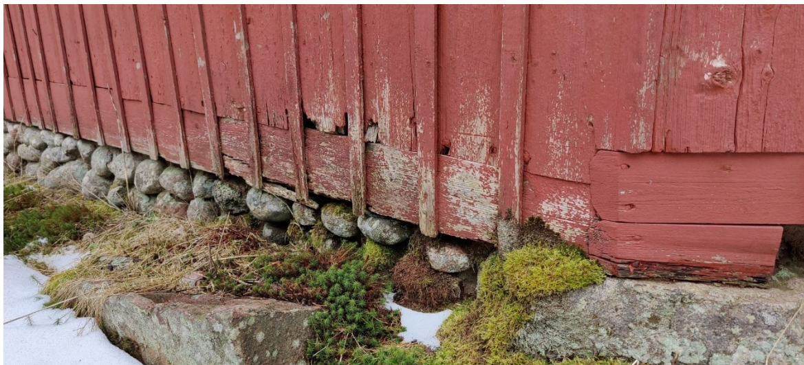
Figur 9 Fuktskada på brädfodring (Isaksson 2021)
