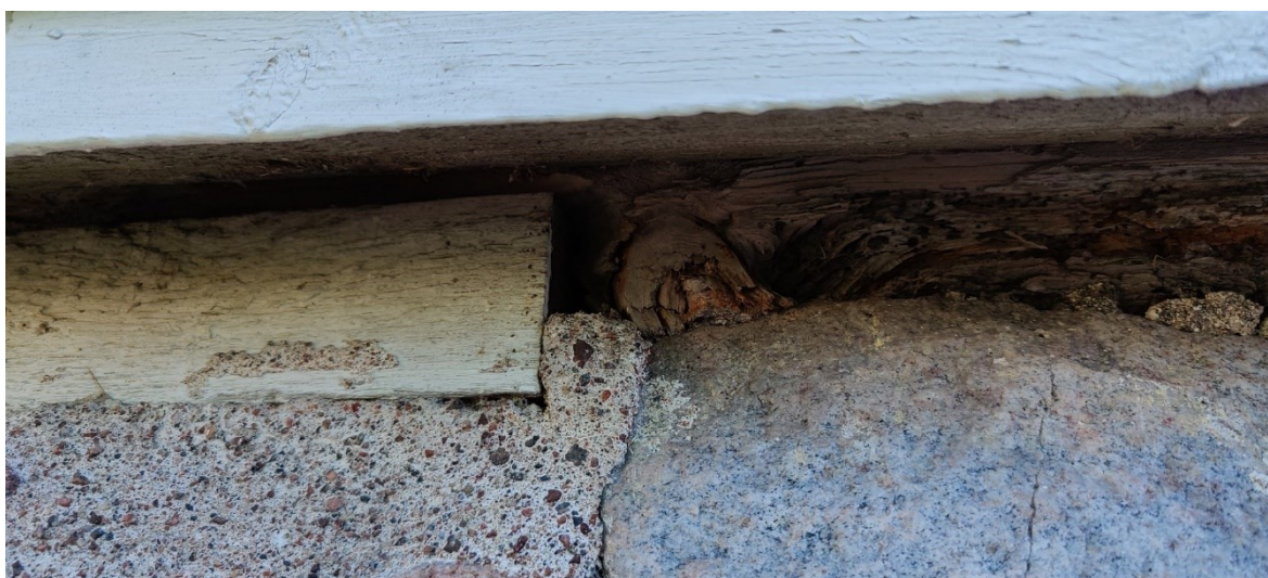
Figur 76 Fuktskada i stocken på östragaveln (Isaksson 2021)
