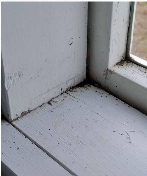
Figur 85 Fuktskada i fönsterkarmen på södra väggen (Isaksson 2021)
