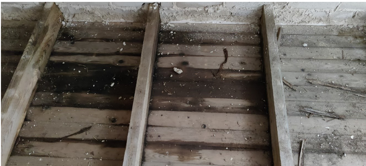
Figur 66 Vatten från kapellets kors som har runnit längs med plåten och ner på mellantaket (Isaksson 2021)
