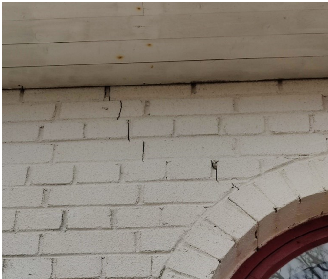
Figur 43 Sprickbildning södra väggen vid mittersta fönstret (Isaksson 2021)
