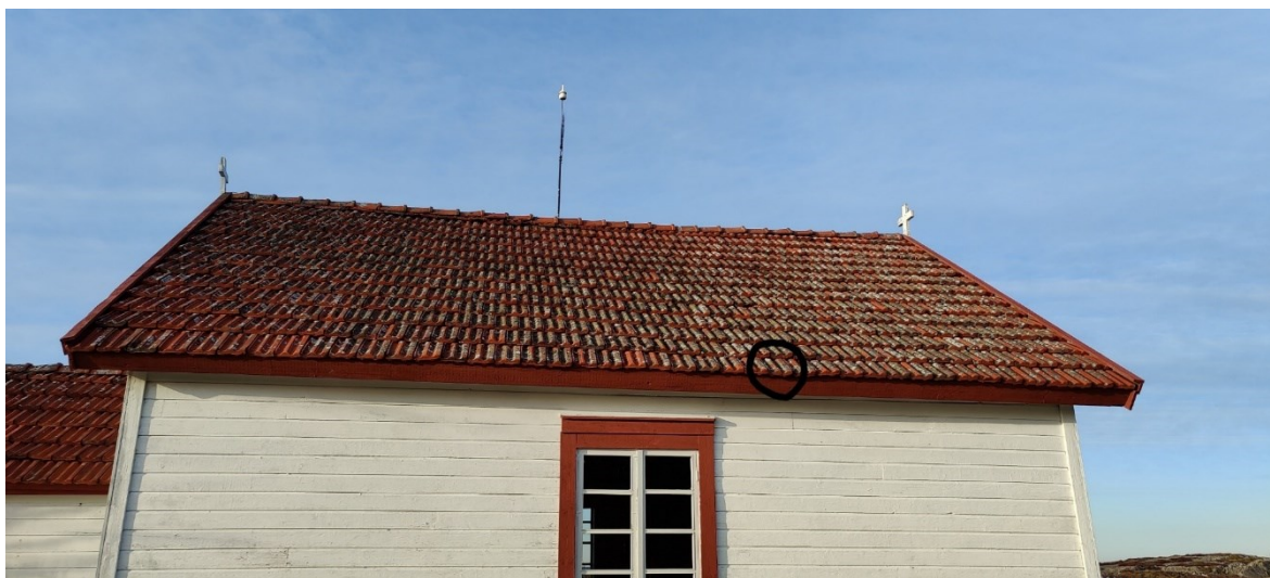
Figur 95 Taket på södra sidan. Sprucket tegel utmärkat med svart cirkel (Isaksson 2021)
