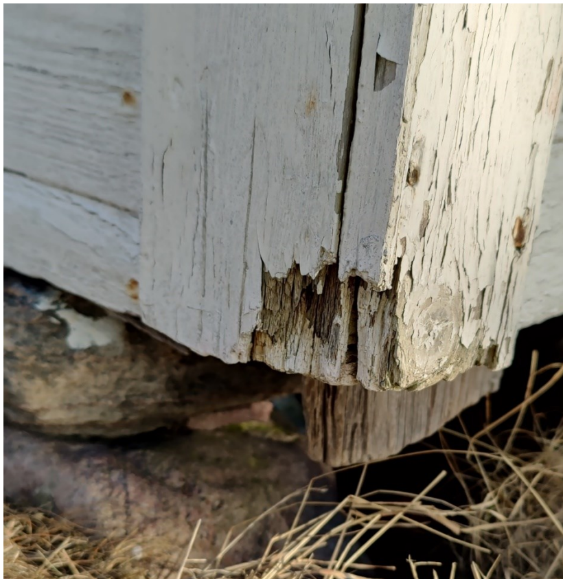
Figur 78 Hörnbrädet i nordvästra hornet skadat (Isaksson 2021)
