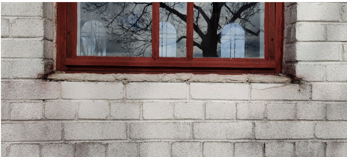
Figur 56 Fönsterbleck saknas vid fönster nr. 203 (Isaksson 2021)
