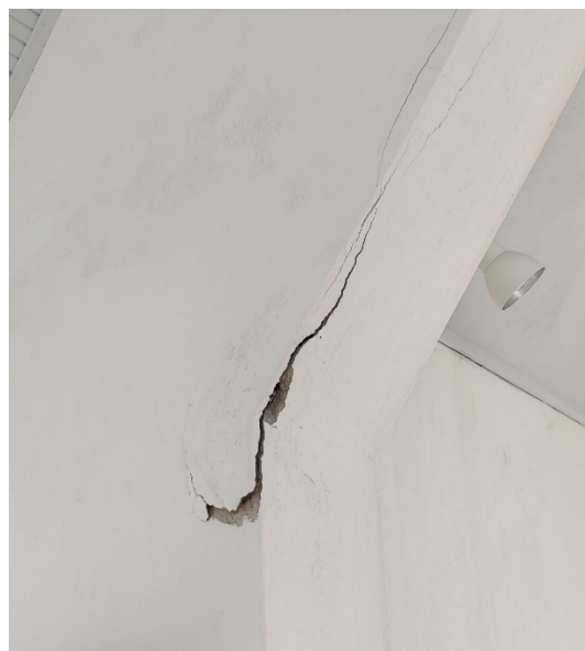
Figur 46 Sprickbildning på vänstra sidan av altaret (Isaksson 2021)
