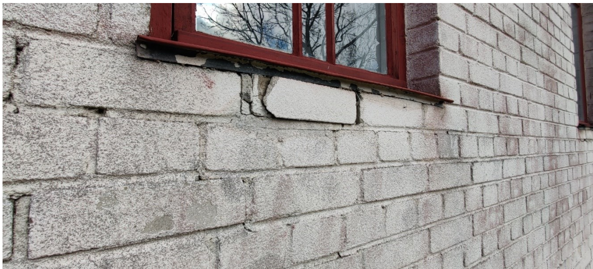
Figur 48 Lösa tegelstenar under fönstren (Isaksson 2021)
