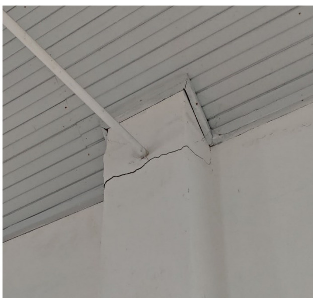
Figur 45 Sprickbildning vid tvärgående stångens fäste (Isaksson 2021)
