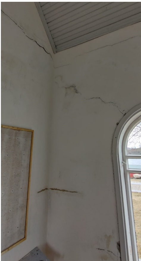
Figur 68 Sprickbildning på högra sidan om altaret (Isaksson 2021)
