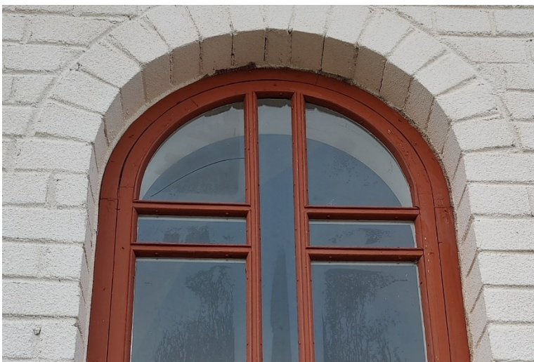
Figur 57 Spricka i fönster nr. 302 (Isaksson 2021)
