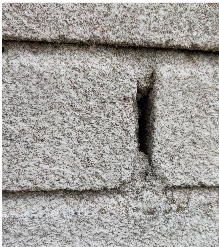
Figur 49 Murbruk saknas mellan tegelstenarna (Isaksson 2021)
