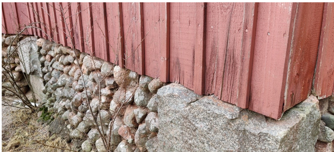
Figur 20 Fuktskador på sakristians brädfodring (Isaksson 2021)
