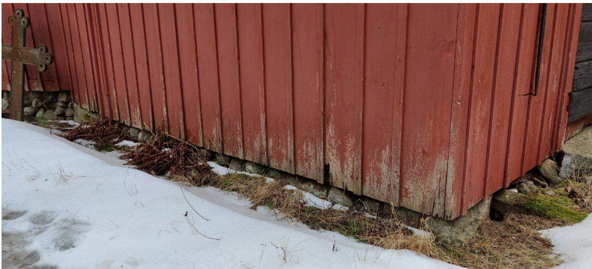
Figur 23 Fuktskada på tamburens norra vägg (Isaksson 2021)
