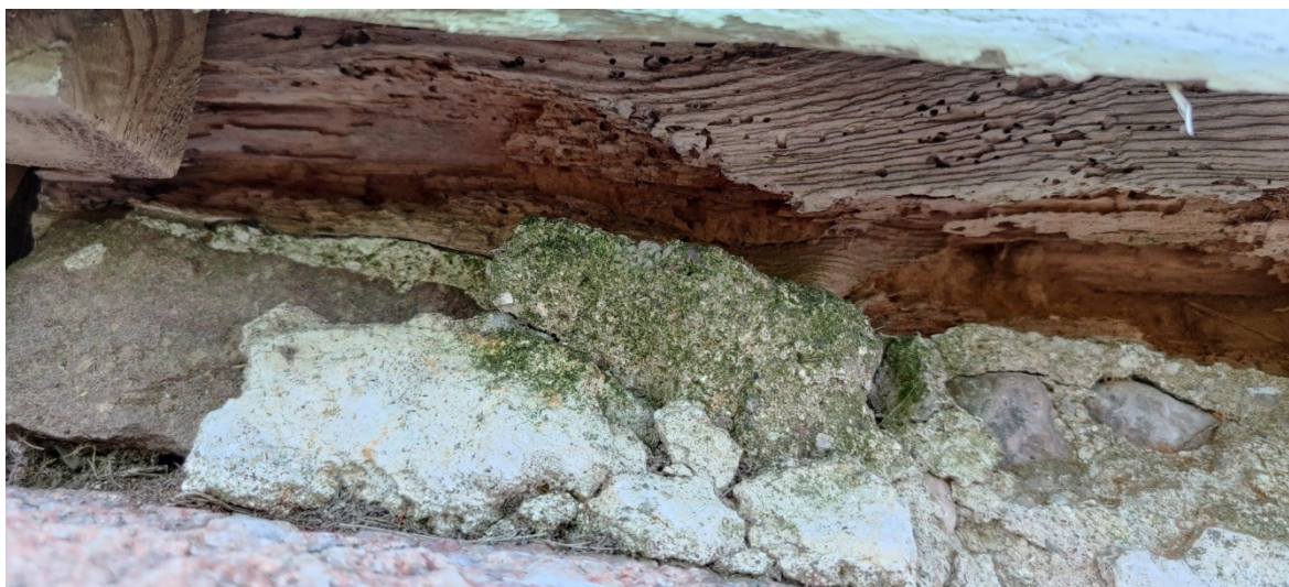
Figur 77 Fuktskada i stocken i nordöstra hörnet (Isaksson 2021)
