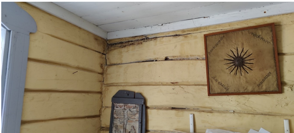
Figur 11 Fuktskada på stommen i sakristian (Isaksson 2021)
