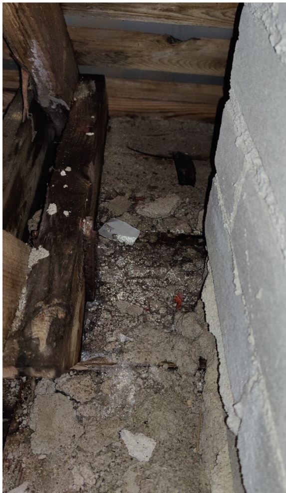
Figur 63 Läckage vid kapellets skorsten (Isaksson 2021)
