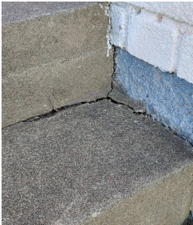
Figur 41 Sprickbildning i trappan (Isaksson 2021)
