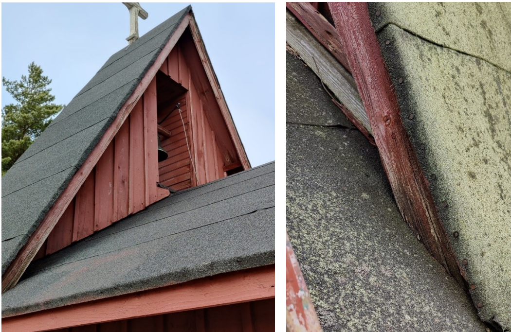
Figur 25 (Klocktornet) och Figur 26 (Tornets hängbräde fuktskadat) (Isaksson 2021)
