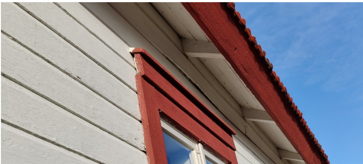
Figur 81 Uttryckt panel under täckan på södra väggen (Isaksson 2021)
