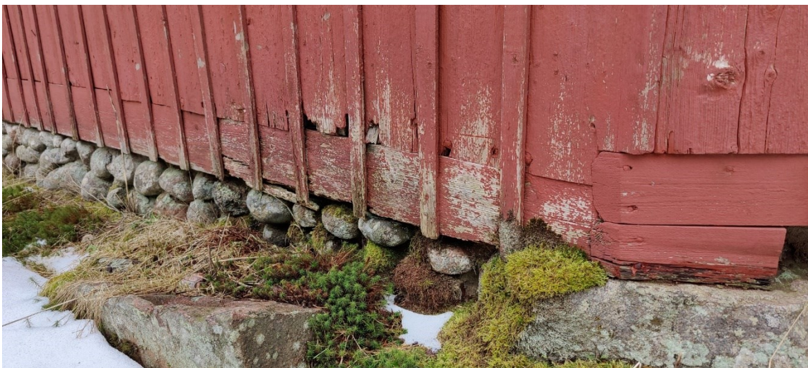
Figur 22 Fuktskada på norra väggen (Isaksson 2021)
