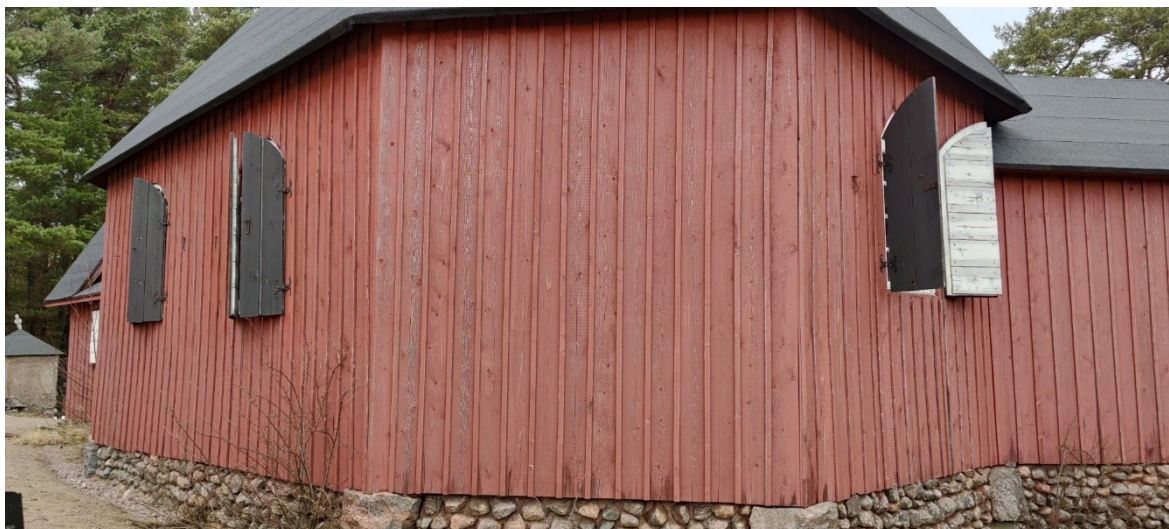
Figur 16 Fukt i brädfodringen intill grund (Isaksson 2021)
