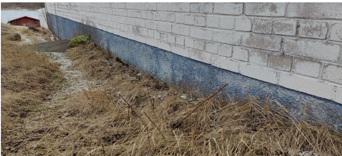
Figur 40 Målfärgen har flagnat på rappningen på norra sidan (Isaksson 2021)
