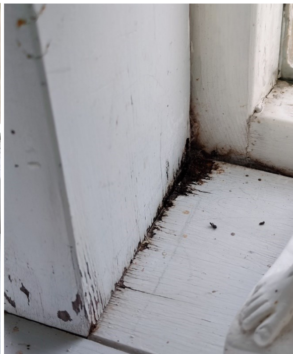
Figur 86 Fuktskada i fönsterkarmen på östra väggen (Isaksson 2021)
