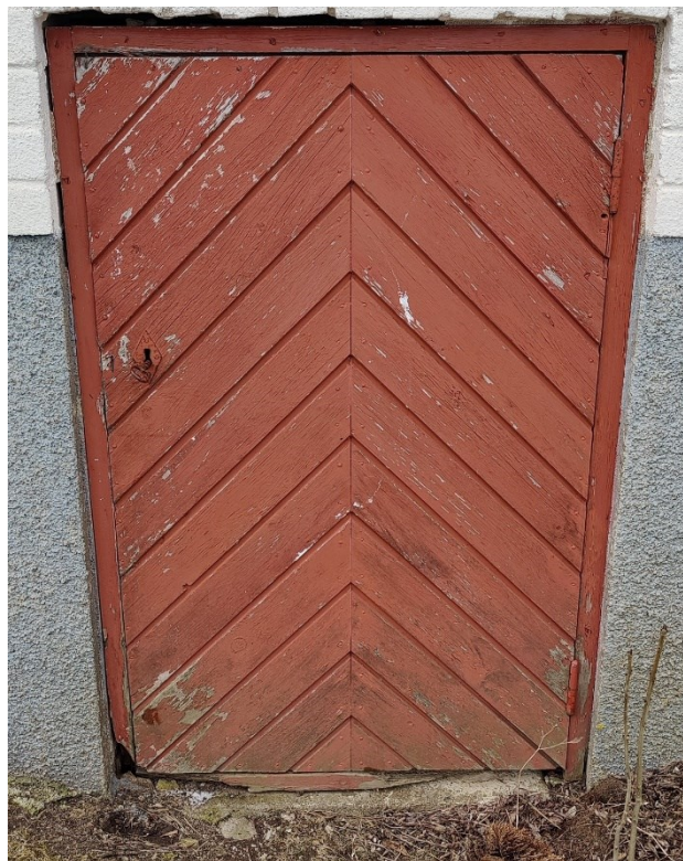
Figur 61 Källardörr. Skador vid tröskeln och karmens vänstra nedre del (302.2) (Isaksson 2021)
