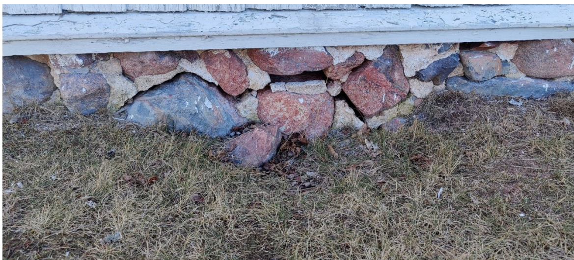
Figur 73 Murbruk har lossnat på östra gaveln (Isaksson 2021)
