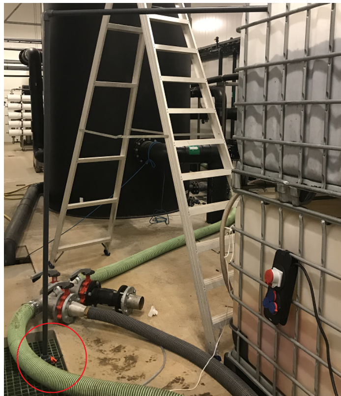
Figur 3. Inloppsroret med reglerventil
