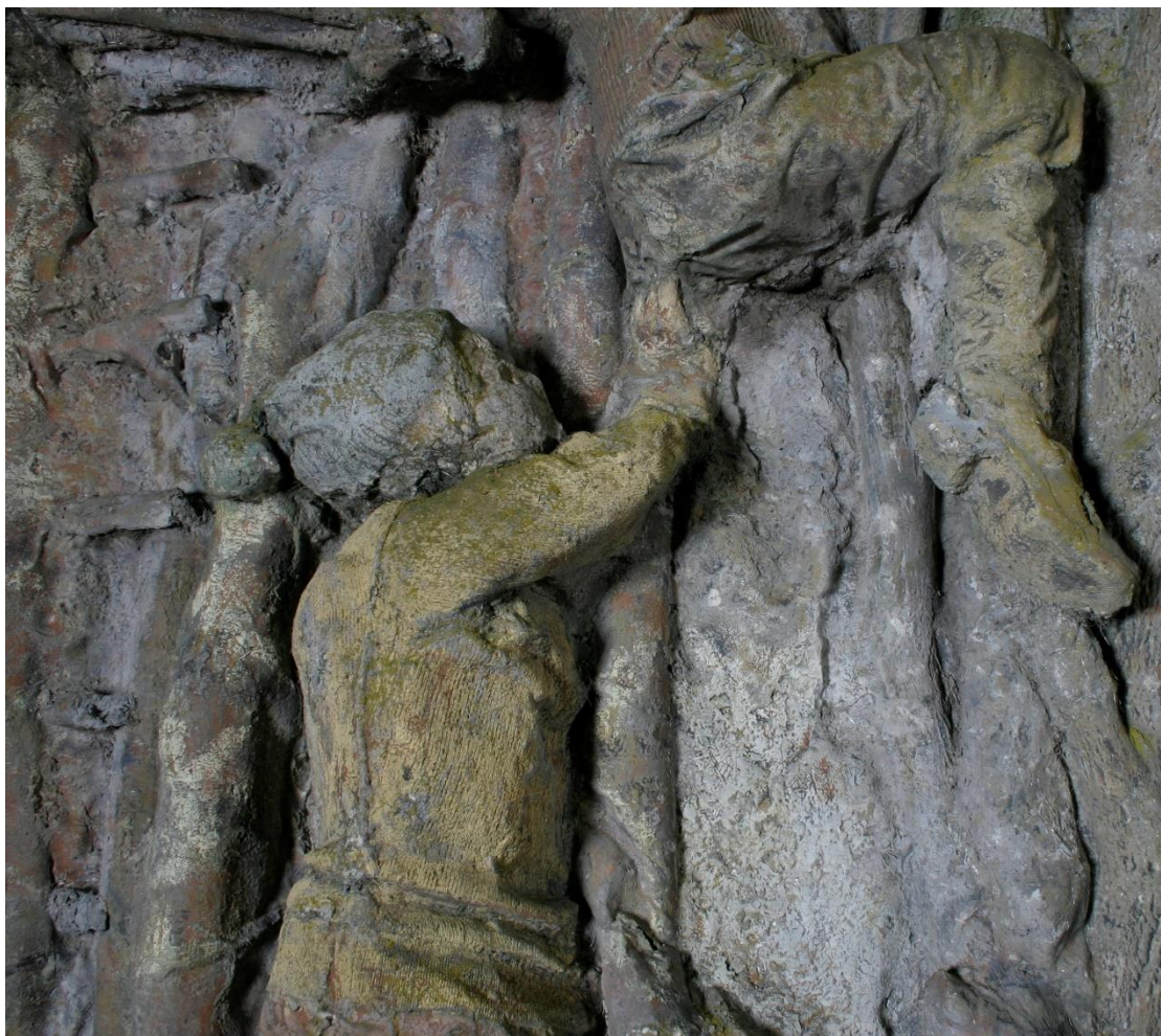
Kuva 10 Lohkeamia ja kasvustoa betonin pinnassa (Rantamäki 2021)
