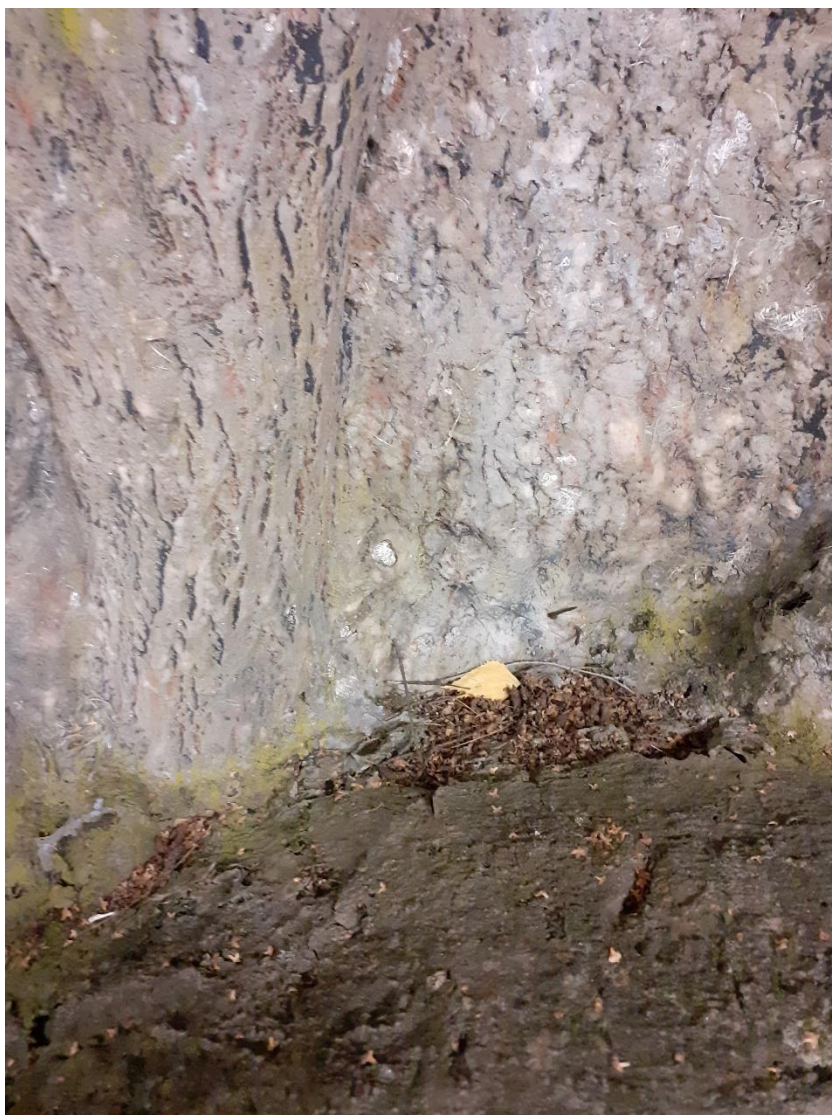
Kuva 11 Pinttynyttä likaa kaivonrenkaan yläpuolelta (Rantamäki 2021)
