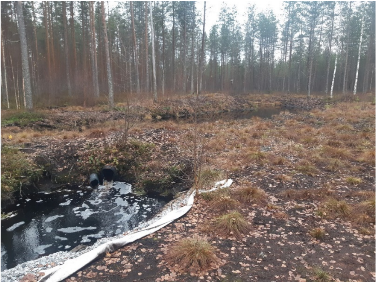
Kuva 13. Kissapuron alajuoksun varteen syksyllä 2015 kaivettu metsäojitusalueen laskeutusallas. Altaasta lähtevään uomaan on äskettäin asetettu lujitemuovinen pressu ja sen päälle painoksi sepeliä eroosiosuojaukseksi.
